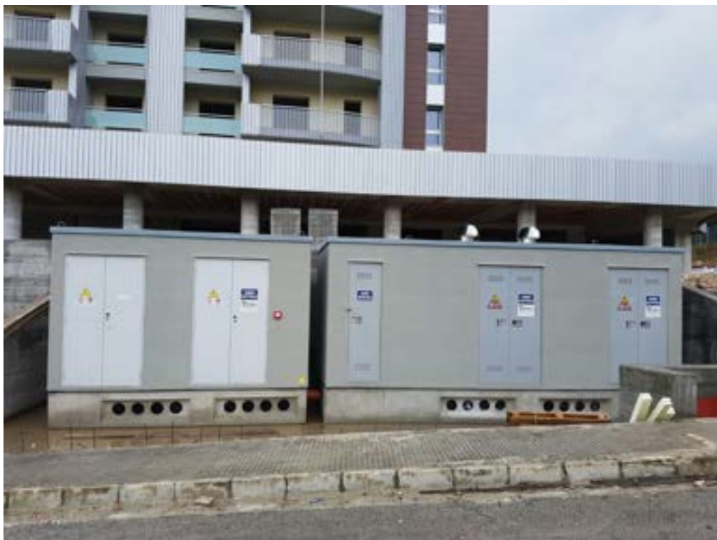
Figura 97. Particolare delle cabine. A sinistra vano trasformatore e quadro di media tensione di proprietà. A destra vano misura e vano di consegna del distributore.
