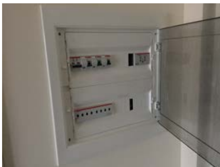
Figura 81. Quadro elettrico/domotico di unità.
