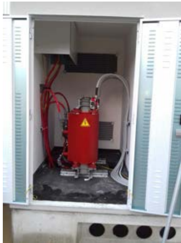
Figura 98. Particolare del vano conil trasformatore da 400 kVA.
