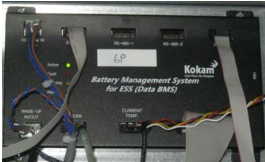
Figura 80: BMS batterie Kokam.
