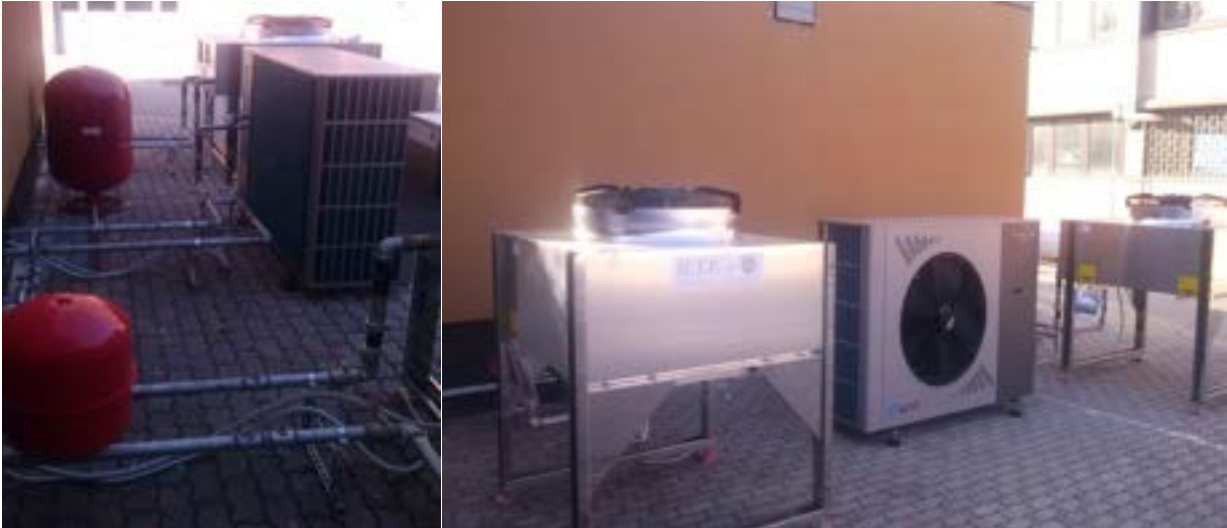
Figura 120: Dettagli vasi di espansione e unità esterne (dry cooler e pompa di calore ) durante la fase di installazione
