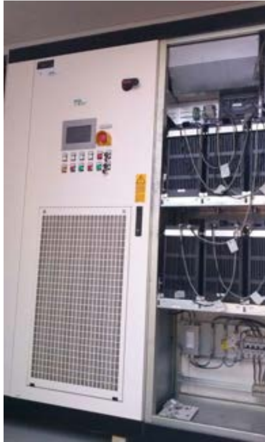
Figura 124: Inverter bidirezionale 30 kVA installato in cabina 1 - sei batterie a Litio Kokam da 16 kWh, 70 Ah
