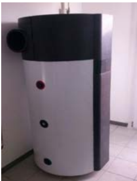
Figura 160: pompa di calore per ACS posizionata nel laboratorio sperimentale islands in island di Lampedusa
