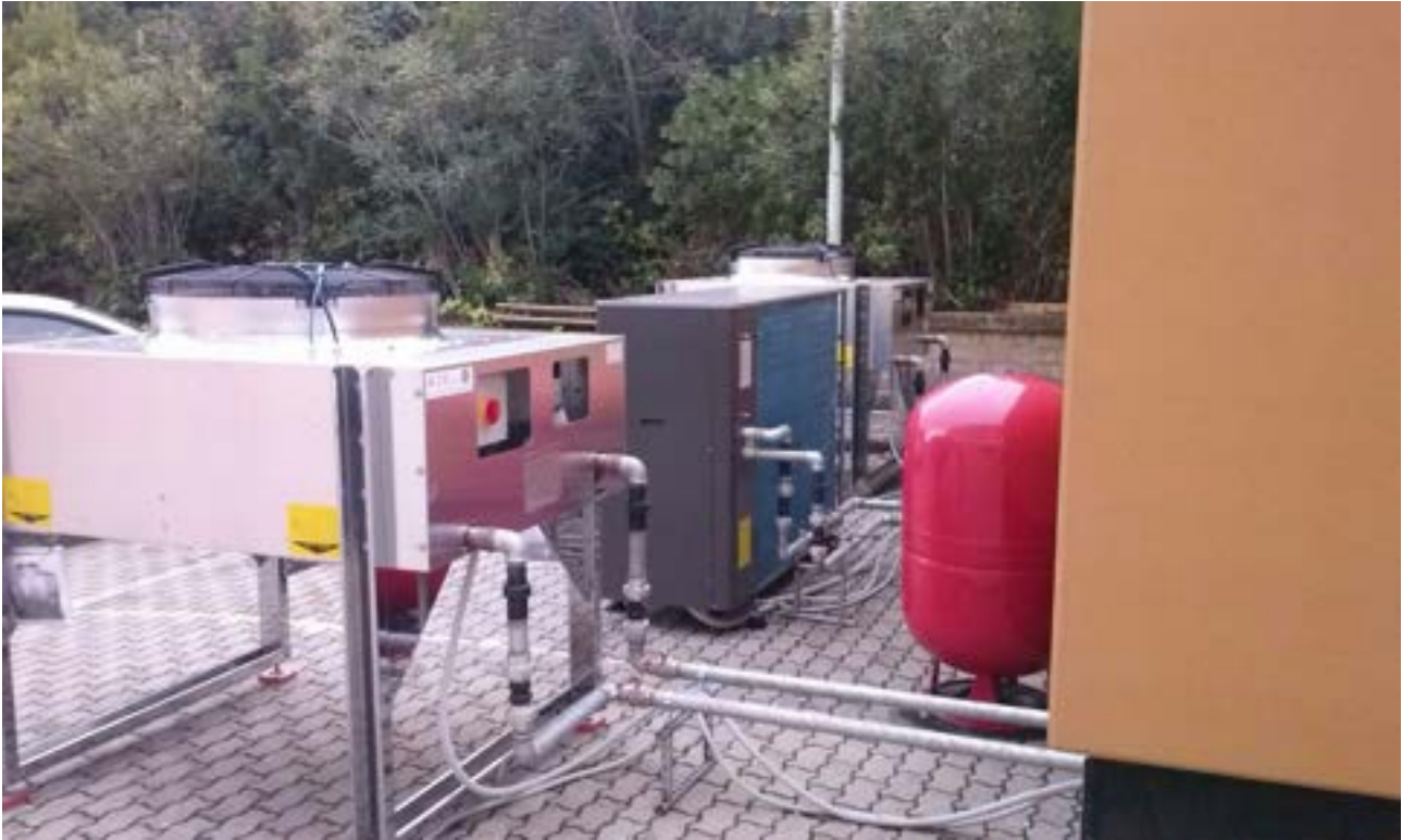
Figura 122: connessione unità esterne: due drycooler e pmpa di calore
