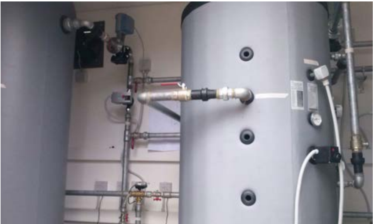
Figura 123: dettaglio accumulo ACS in cabina 2- connessione idrauliche, resistenza ausiliaria, sonde attive di temperatura, valvole, circolatore (P2), valvola a tre vie (Vt1)
