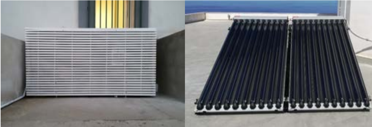
Figura 164: foto installazione unità esterna freescoo facade affiancata alla parete e collettore solare sul tetto dell'edificio
