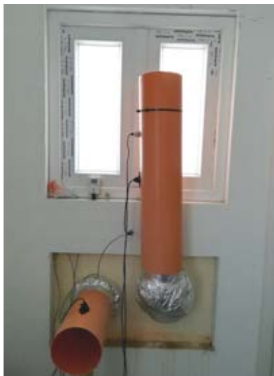
Figura 159: canalizzazione d'aria interna alla cabina sperimentale
