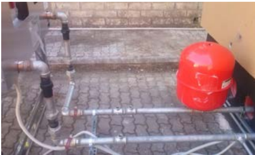
Figura 121: circuito idraulico dry cooler per ACS – dettaglio giunti dielettrici e smorzatori
