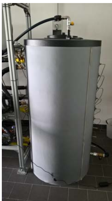
Figura 19. Serbatoio di accumulo termico
