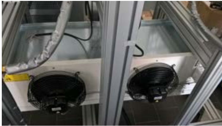
Figura 21. Foto dello scambiatore di calore utilizzato per simulare i carichi di refrigerazione dell'utenza.
