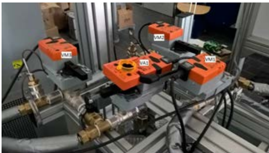
Figura 24. Valvole per il controllo delle portate.
