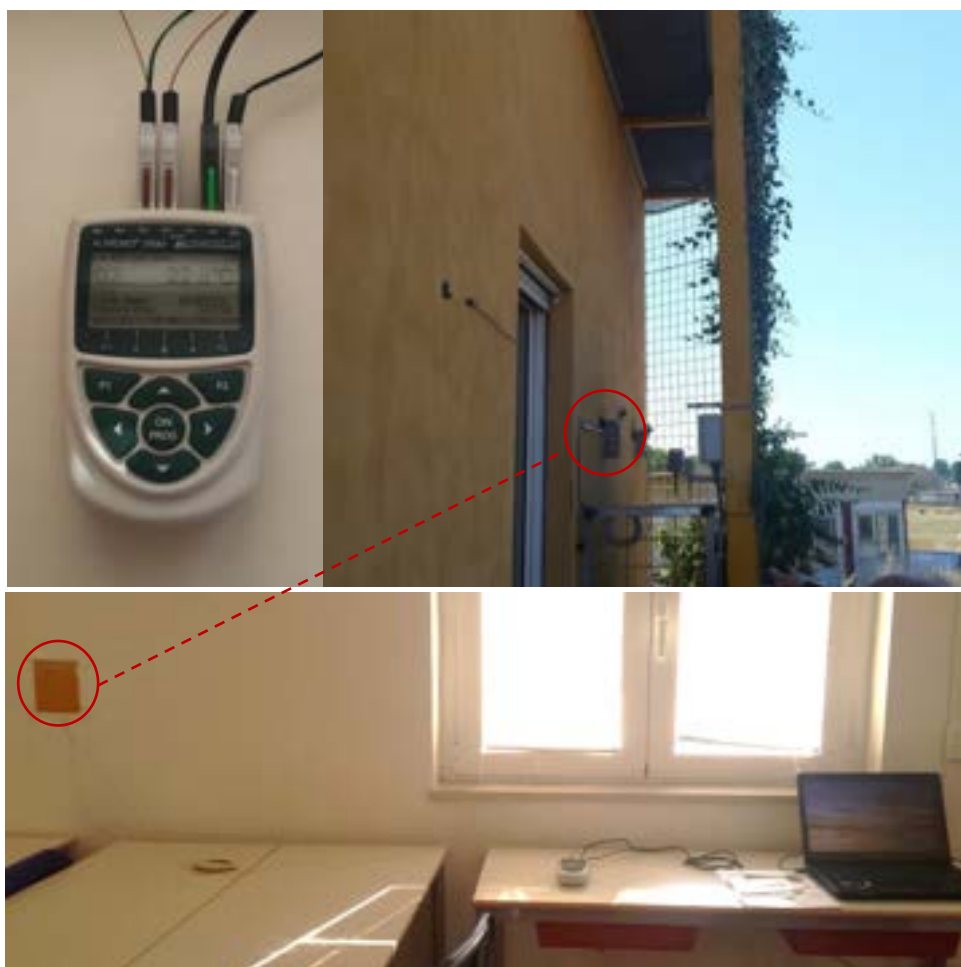
Figura 51: sistema di monitoraggio termocoppie + datalogger
