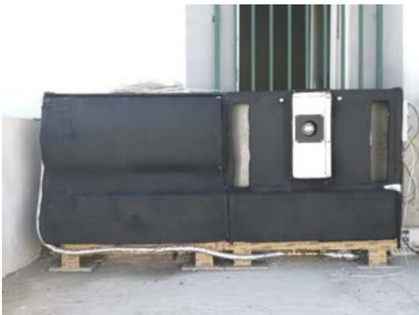
Figura 174 Sistema freescool facade durante l'installazione alla sede ENEA al faro di Grecale a Lampedusa
