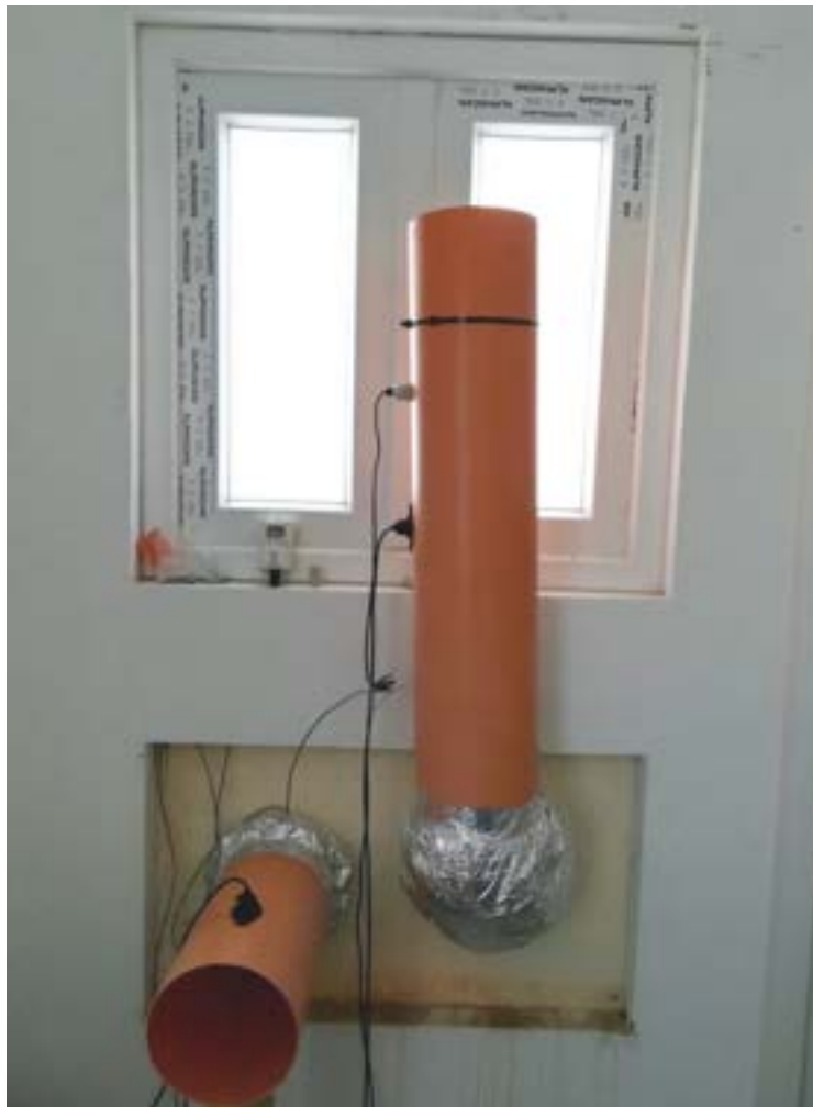
Figura 135 Canalizzazioni dell'aria di mandata e ripresa con relativi sensori di temperatura, umidità relativa e velocità dell'aria
