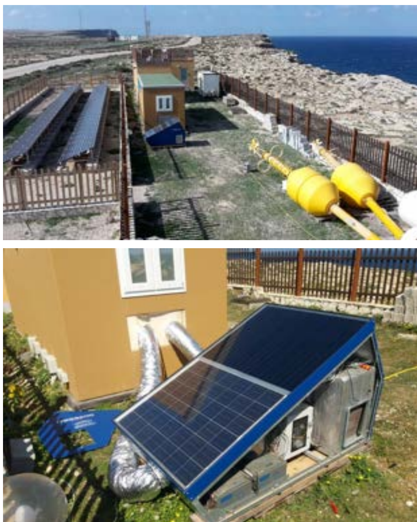
Figura 134 Foto del sistema freescoo stand-alone installato presso il centro ricerche ENEA a Lampedusa
