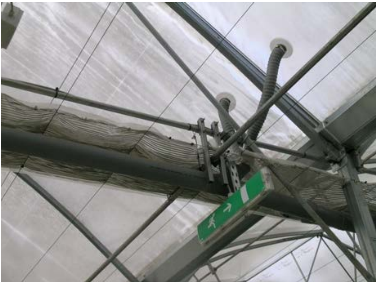
Figura 12: Copertura di una serra realizzata con doppi film plastici con interposta una camera d'aria.
