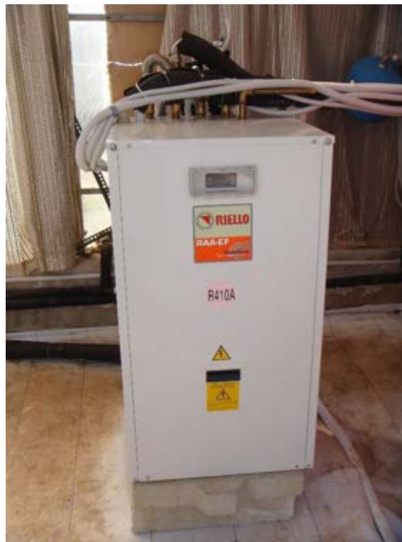
Figura 20: Pompa di calore geotermica all'interno di una serra presso il campo sperimentale dell'Università di Bari
