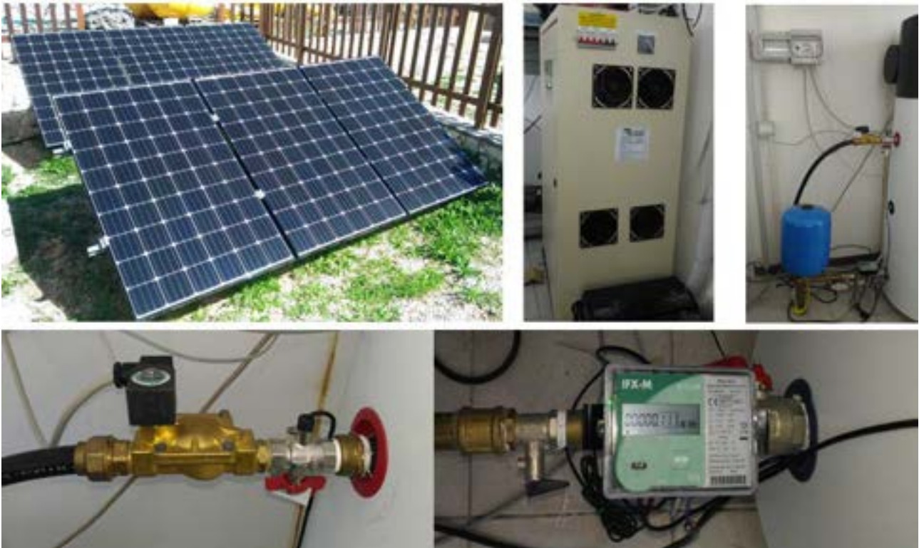
Figura 56: principali componenti impianto sperimentale per la produzione di ACS da FV: moduli fotovoltaici , inverter 1 kVA, circuito idraulico di immissione e prelievo ACS dall'accumulo, particolare valvola motorizzata, contatore energia termica consumata.
