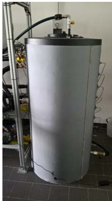
Figura 19. Serbatoio di accumulo termico
