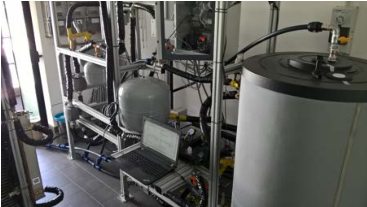
Figura 18. Impianto sperimentale utilizzato per l'implementazione del tool di ottimizzazione
