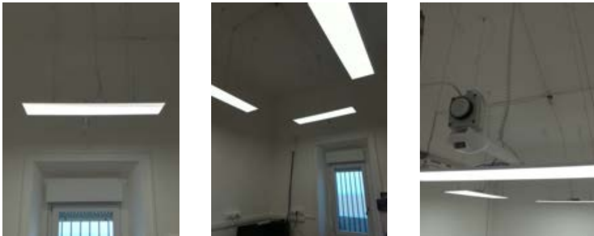
Figura 62 Immagini dell'ambiente con il nuovo sistema installato.
