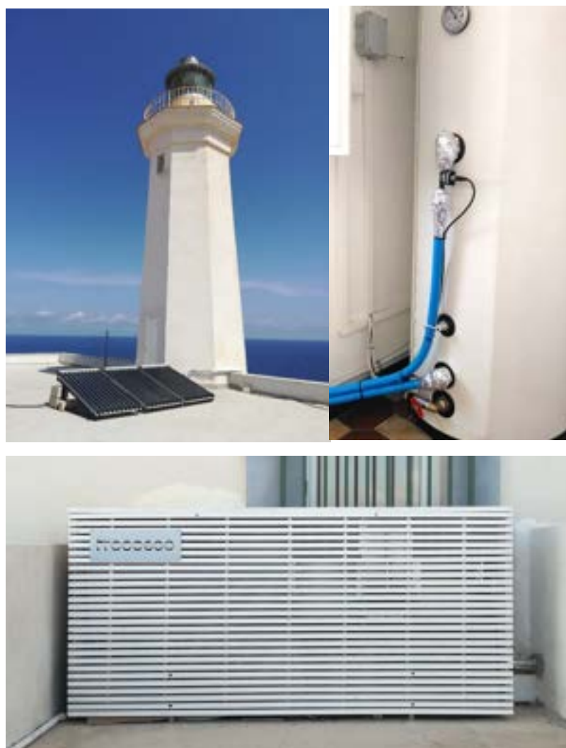
Figura 31 Foto del sistema di climatizzazione freescoo con produzione di acqua calda sanitaria presso il centro di ricerche ENEA al faro di Grecale a Lampedusa
