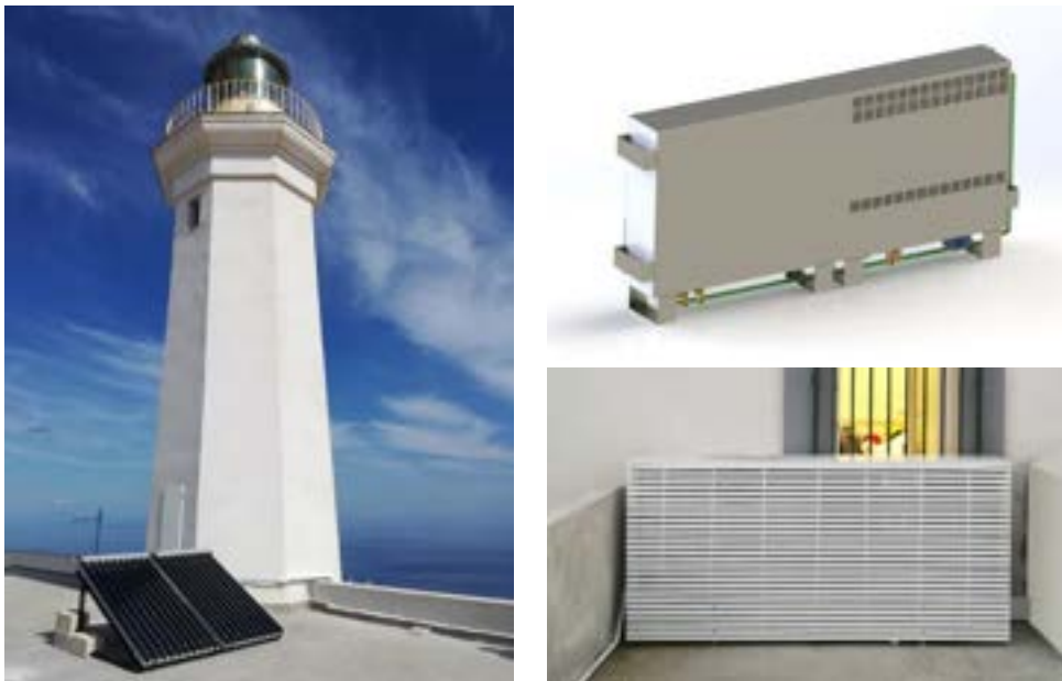
Figura 1 Sistema freescoo installato alla fine del 2017 presso i laboratori ENEA al faro di Grecale a Lampedusa
