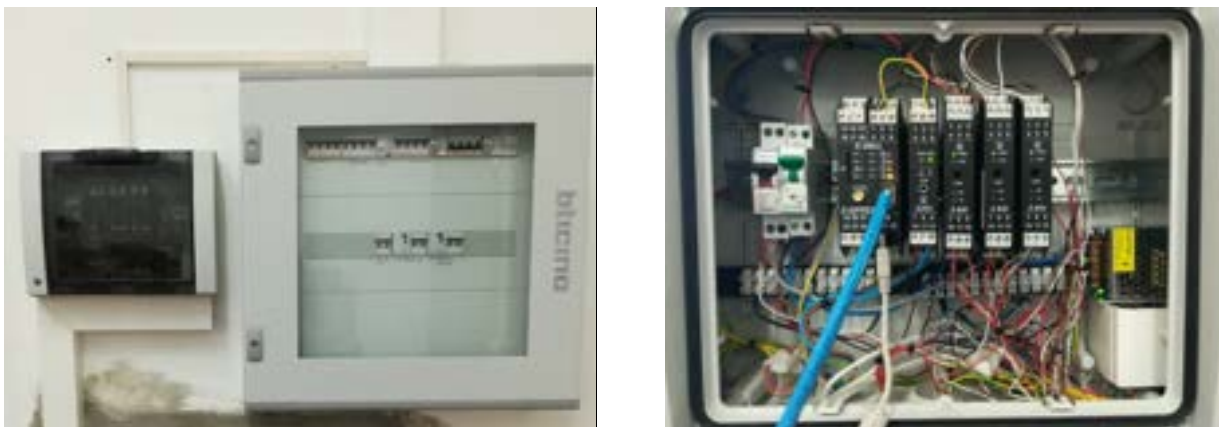
Figura 3 Quadro e sistema di monitoraggio installato a servizio dell'impianto freesco façade
