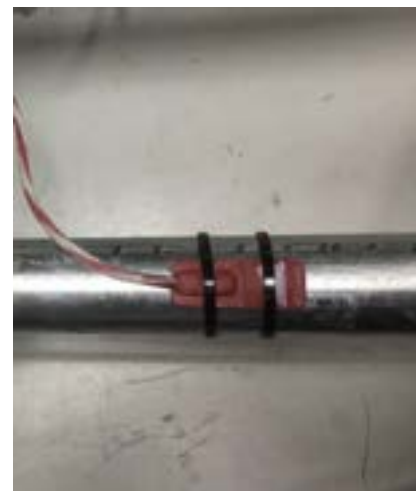
b) sensore di temperatura su tubazione non isolata
