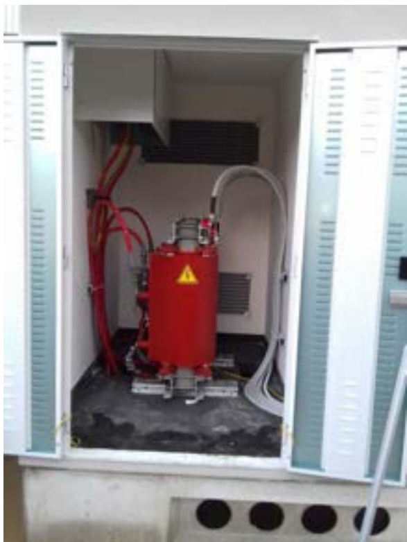
Figura 38. Particolare del vano conil trasformatore da 400 kVA.
