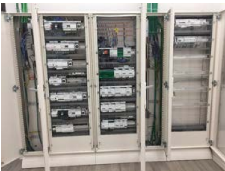
Figura 112. Quadro elettrico della micro grid LAMBDA.
