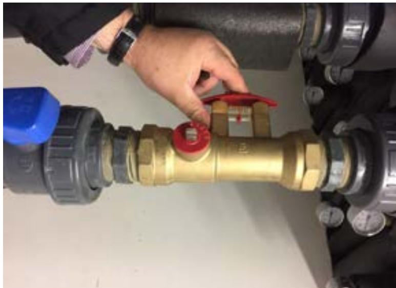
Figura 49. Punto di installazione del misuratoe heat meter del tipo MWN-130-C
