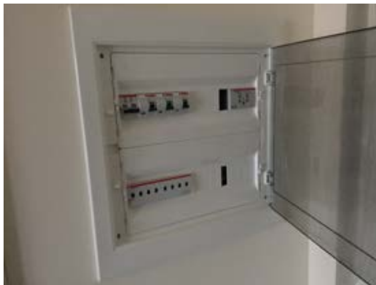
Figura 19. Quadro elettrico/domotico di unità.
