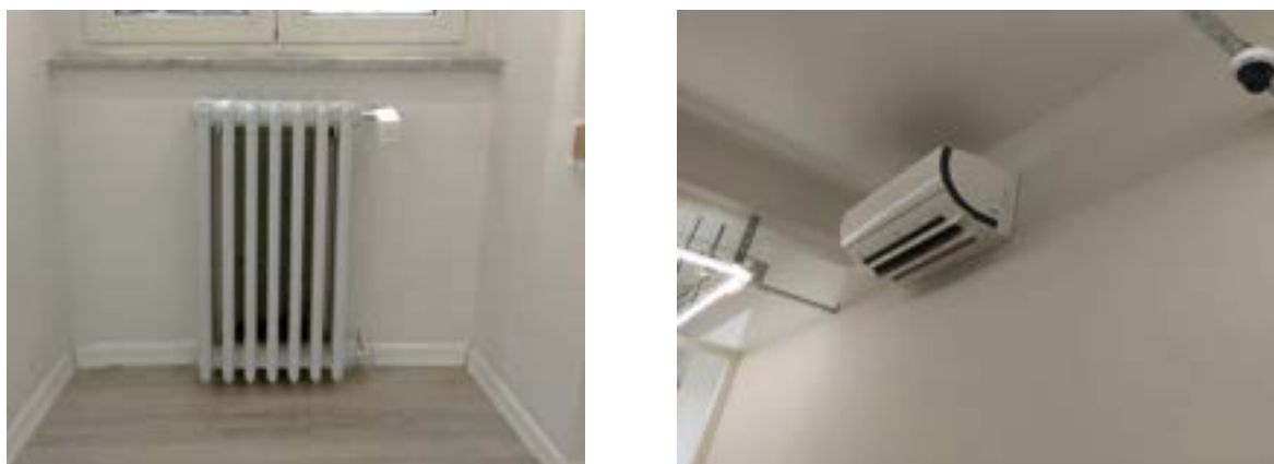
Figura 109. Radiatore tubolare con valvola di regolazione (a sinistra) e condizionatore da parete (a destra)
