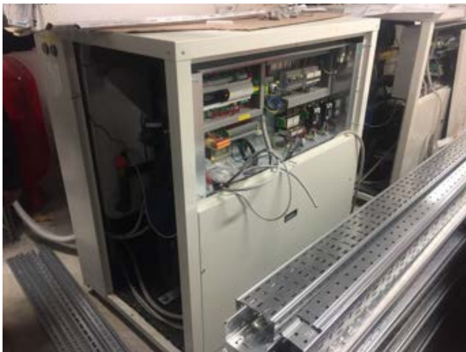
Figura 22. Pompa di calore installata nell’edificio.
