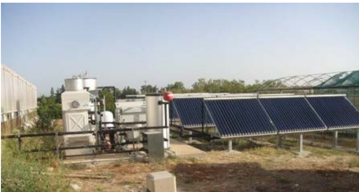
Figura 26: Impianto di solar cooling composto da campo solare, assorbitore, torre evaporativa, serbatoio di accumulo caldo e serbatoio di accumulo freddo, presso il Centro sperimentale "P. Martucci" dell'Università di Bari, Valenzano (BA).
