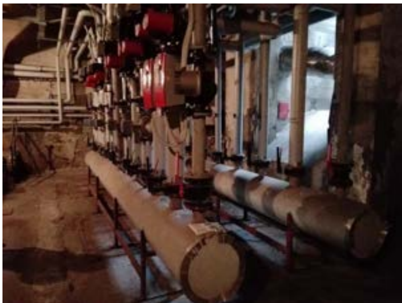
Figura 4.10. Collettori di distribuzione dell'impianto di riscaldamento
