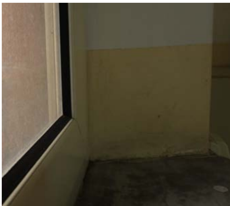
Figura 8: Degrado all'interno della scuola L. Tempesta
