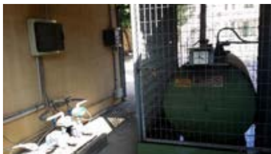
Figura 26: Serbatoio del gasolio
