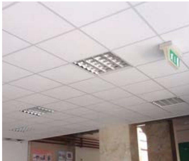
Figura 29. Particolare del sistema di illuminazione artificiale e di quella di emergenza
