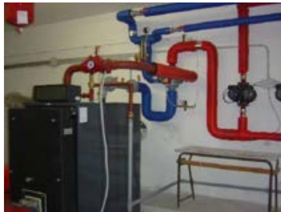
Figura 33. Generatore per produzione acqua calda per riscaldamento in centrale termica
