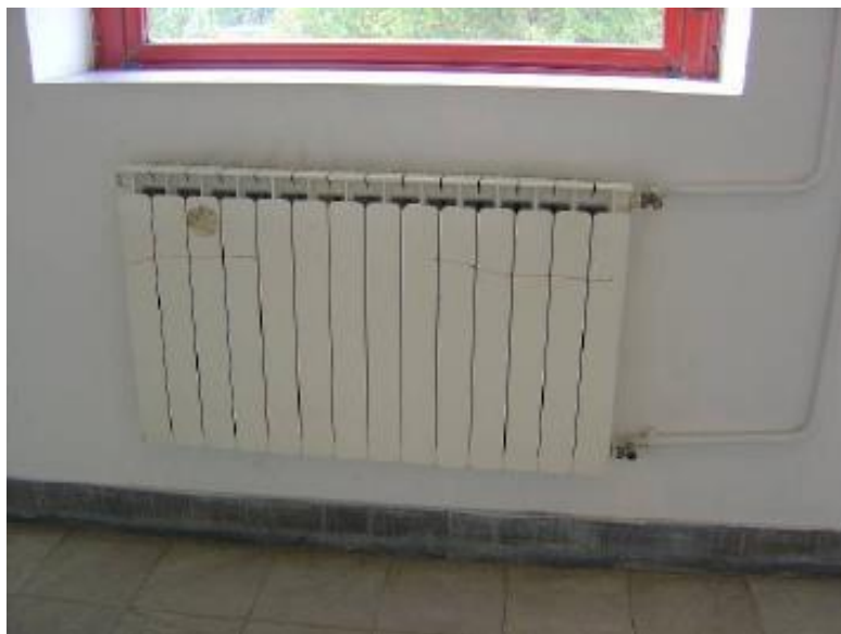
Figura 35. Terminale di scambio termico privo di regolazione locale
