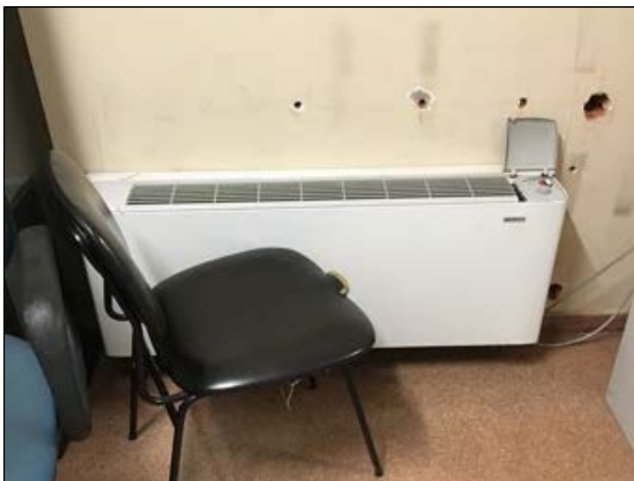
Figura 4.13. Ventilconvettore di recente sostituzione.
