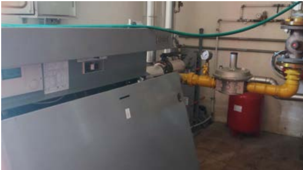
Figura 12: Locale tecnico per la caldaia.
