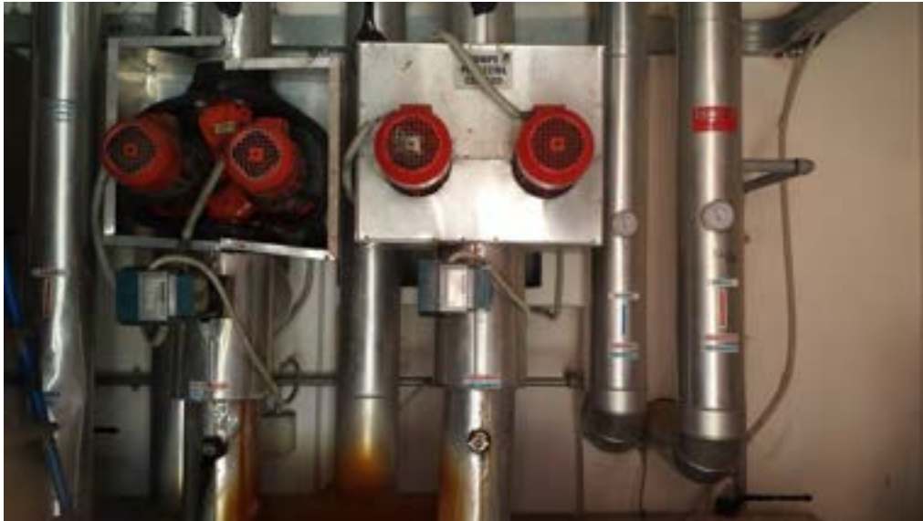
Figura 11: Pompe di distribuzione del sistema di riscaldamento.
