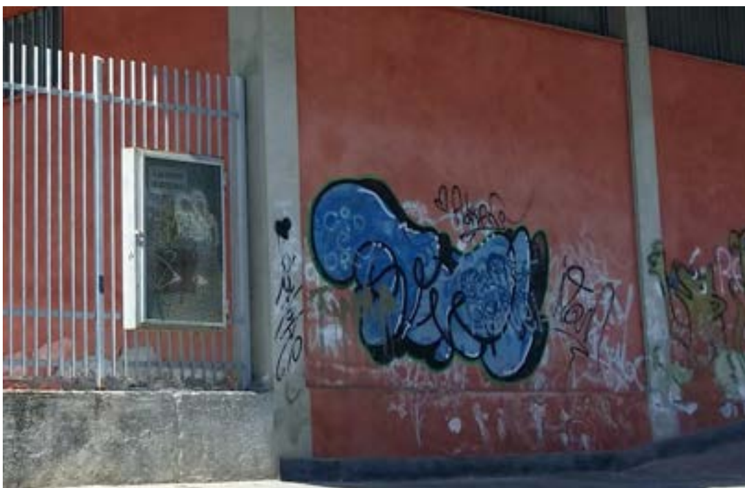
Figura 8. Degrado antropico sulle pareti esterne dell'edificio
