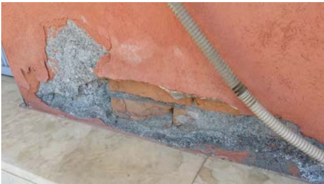
Figura 7. Distaccamento dell'intonaco dovuto all'umidità ascendente
