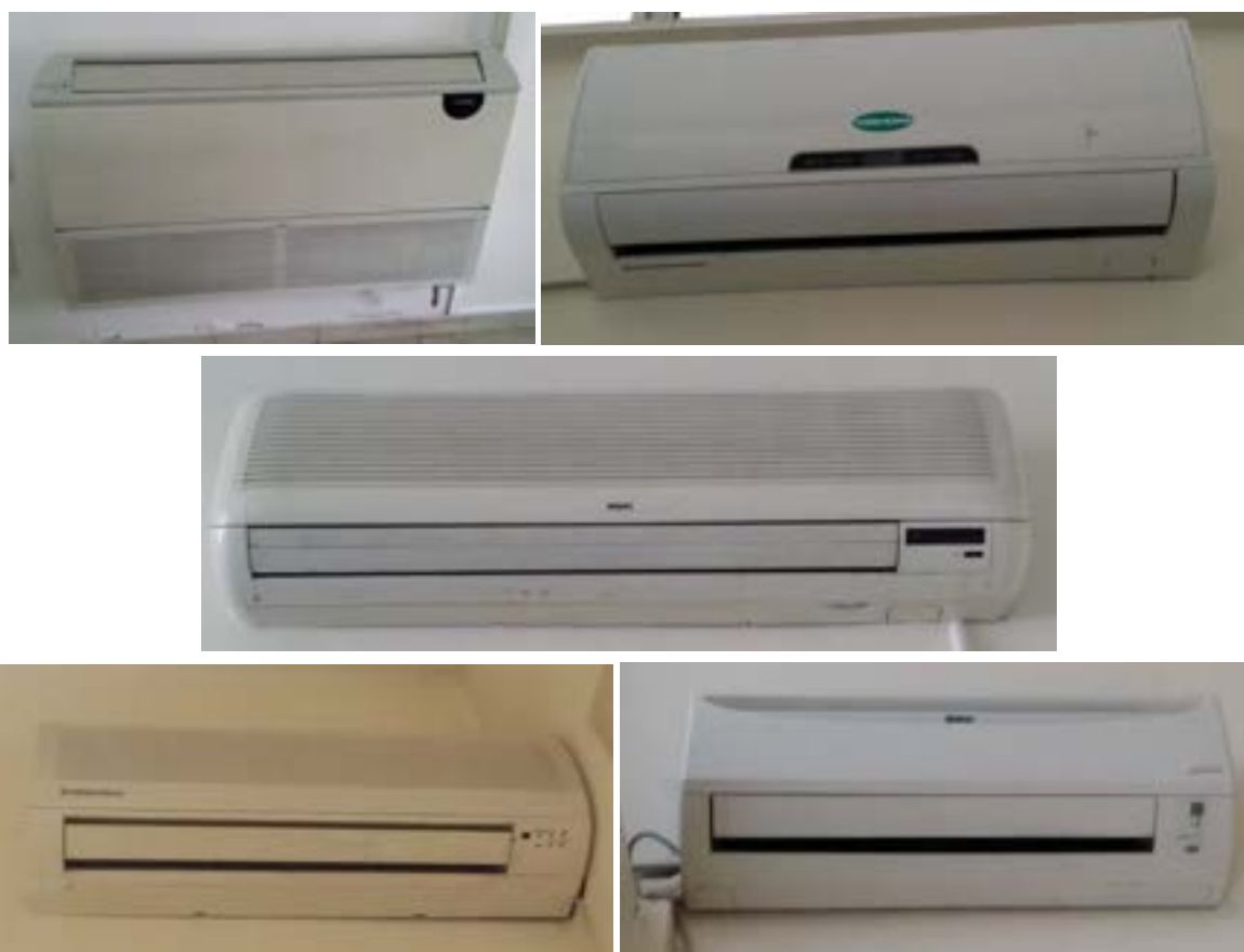
Figura 16. Immagini di alcuni condizionatori presenti nei locali
