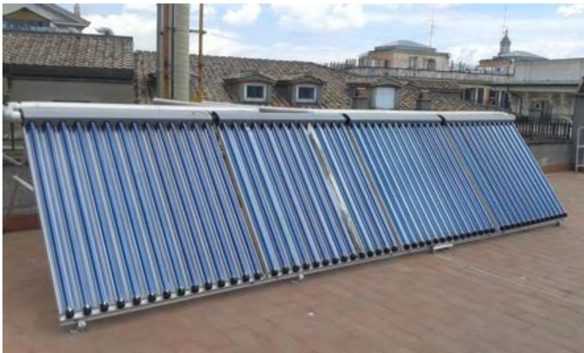
Fig. 8: Collettori solari presenti in copertura
