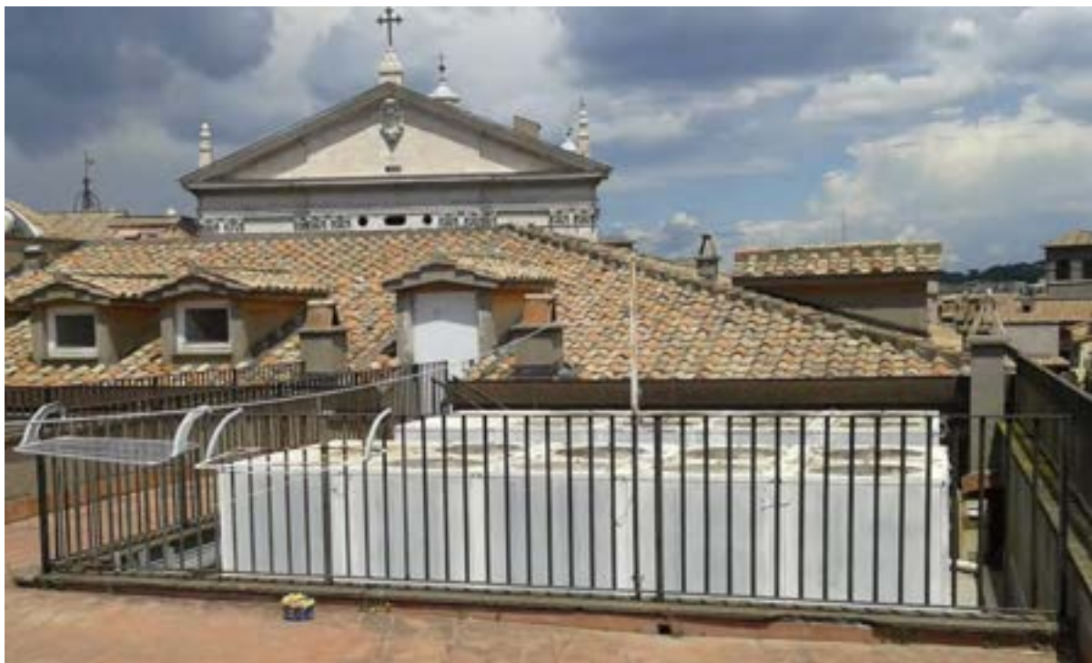
Fig. 7: Chiller dell'UTA presente in copertura
