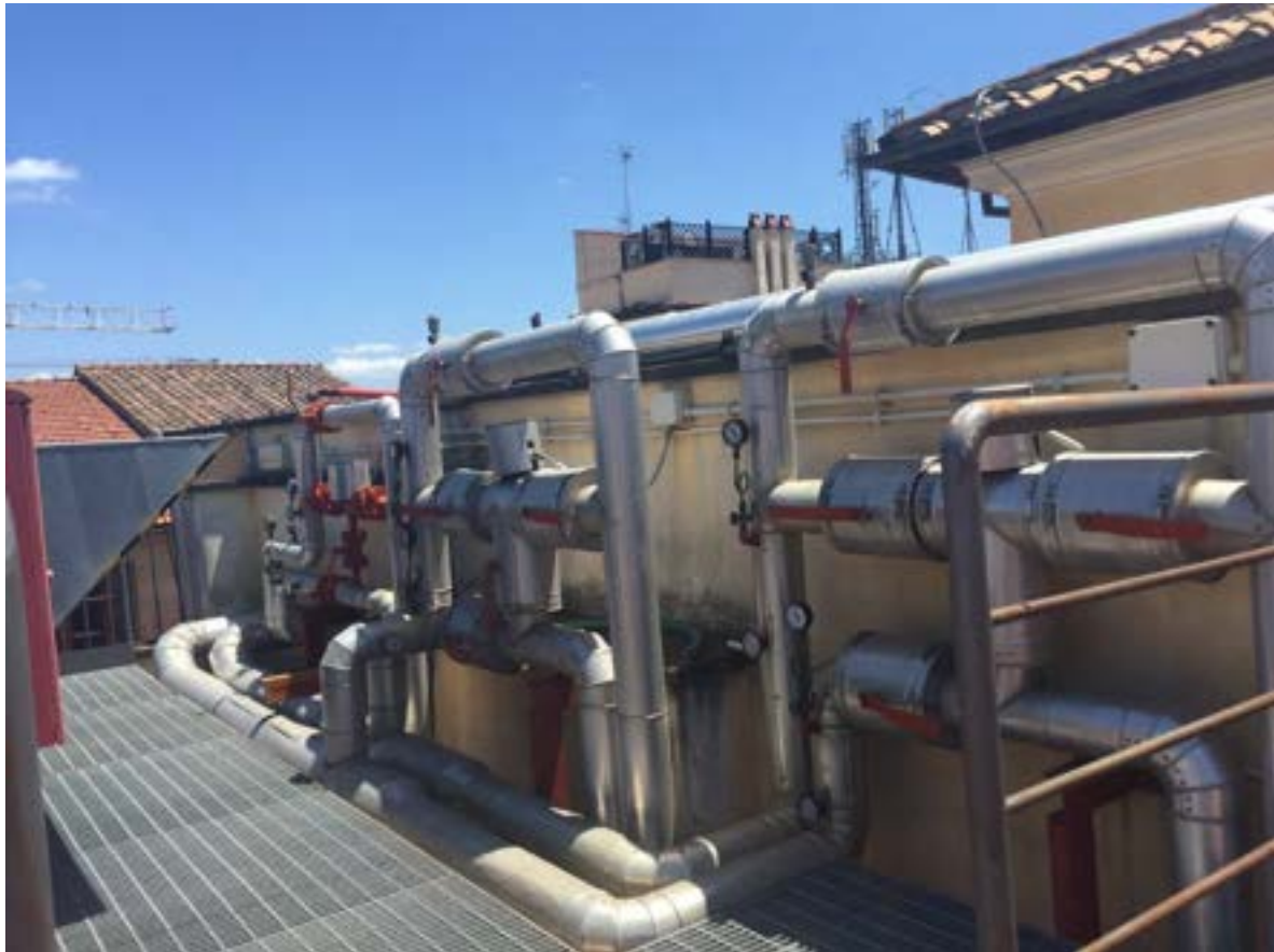
Figura 11: Pompe e le valvole di regolazione della centrale
