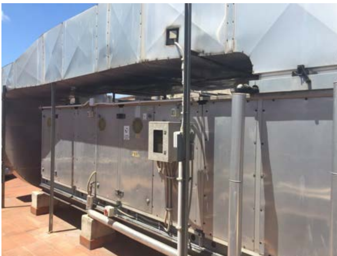
Figura 12: Particolare Uta Uffici B-C-D
