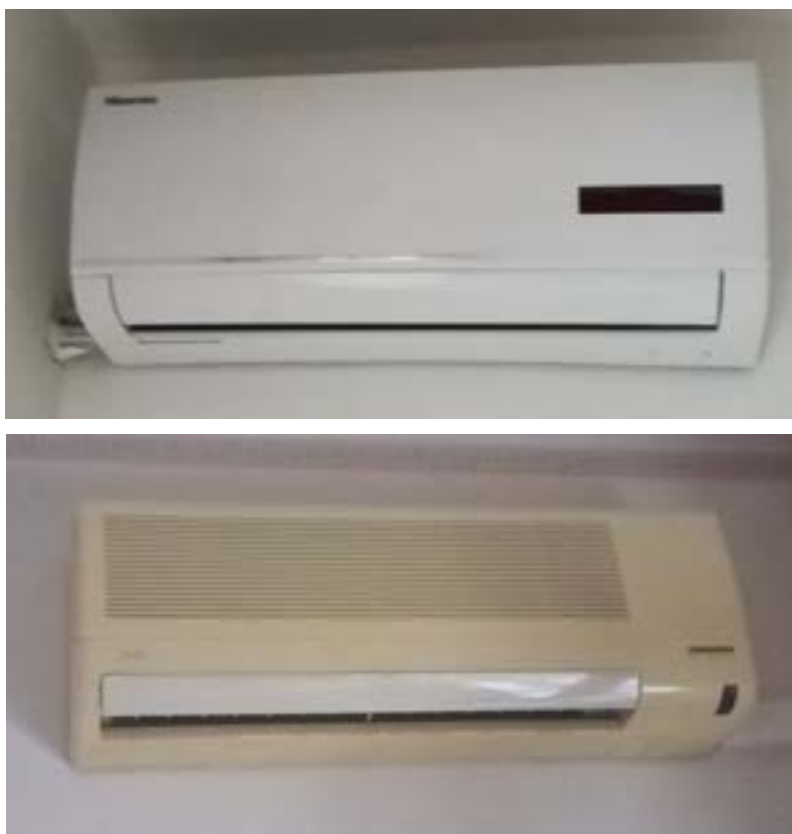
Figura 14. Immagini di alcuni condizionatori split utilizzati
