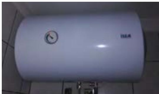
Figura 15. Immagini di un boiler elettrico utilizzato
