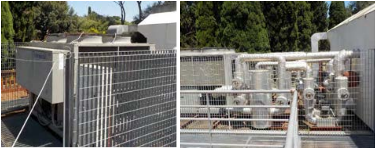
Figura 7.12 – Gruppo polivalente, pompe e serbatoi di accumulo.
