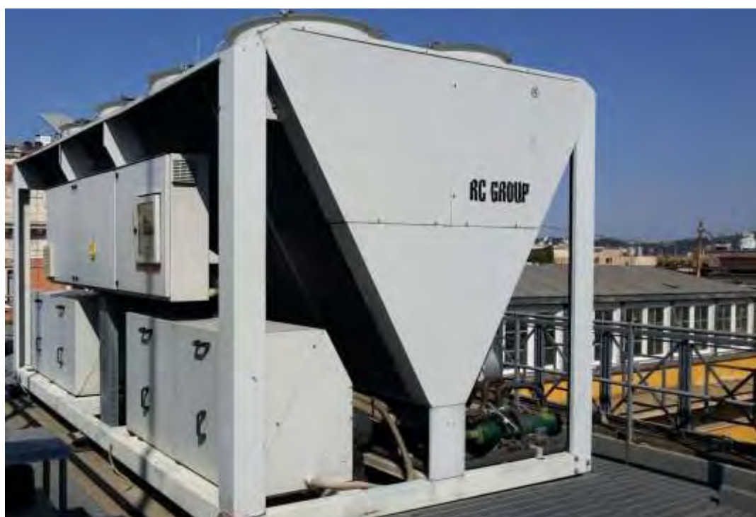
Figura 16: Pompe di calore
