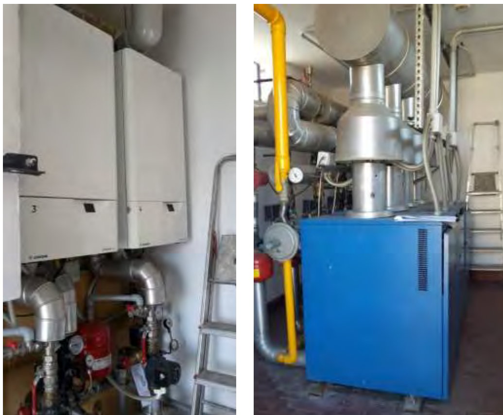
Figura 14: Generatori di calore Junkers e Bongioanni
