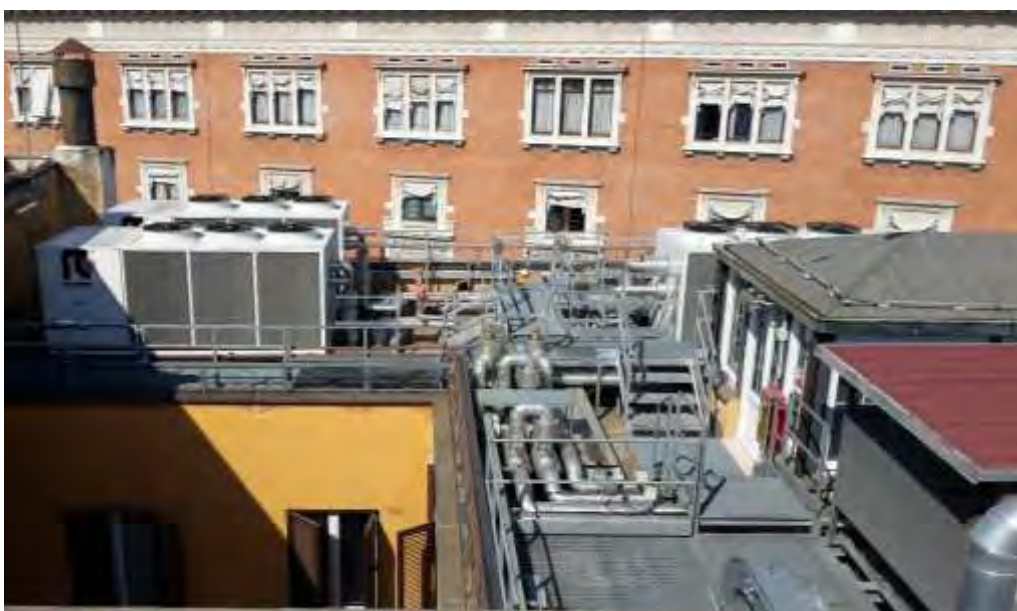
Figura 17: Vista dall'alto degli impianti termici
