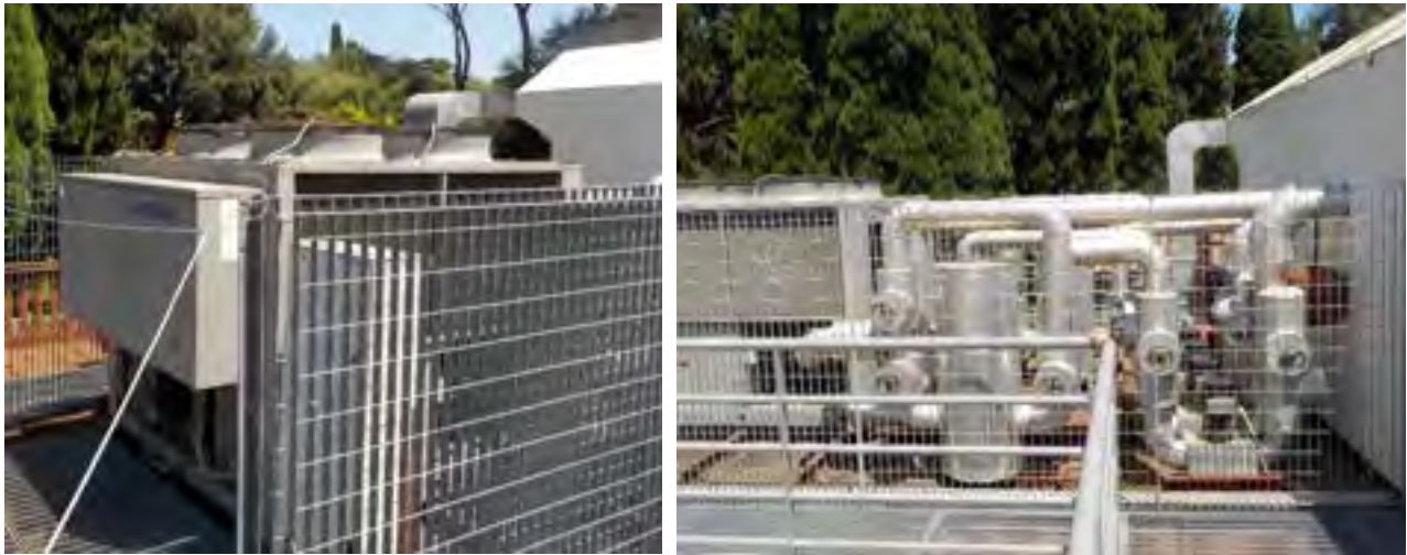
Figura 3.12 – Gruppo polivalente, pompe e serbatoi di accumulo.
