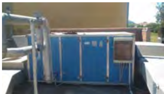
Figura 5.2.2. UTA a servizio della zona commerciale
