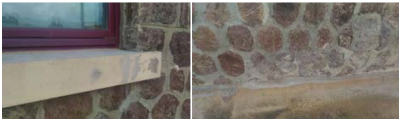
Figura 68. Segni di Infiltrazioni dagli infissi Museo PAS
