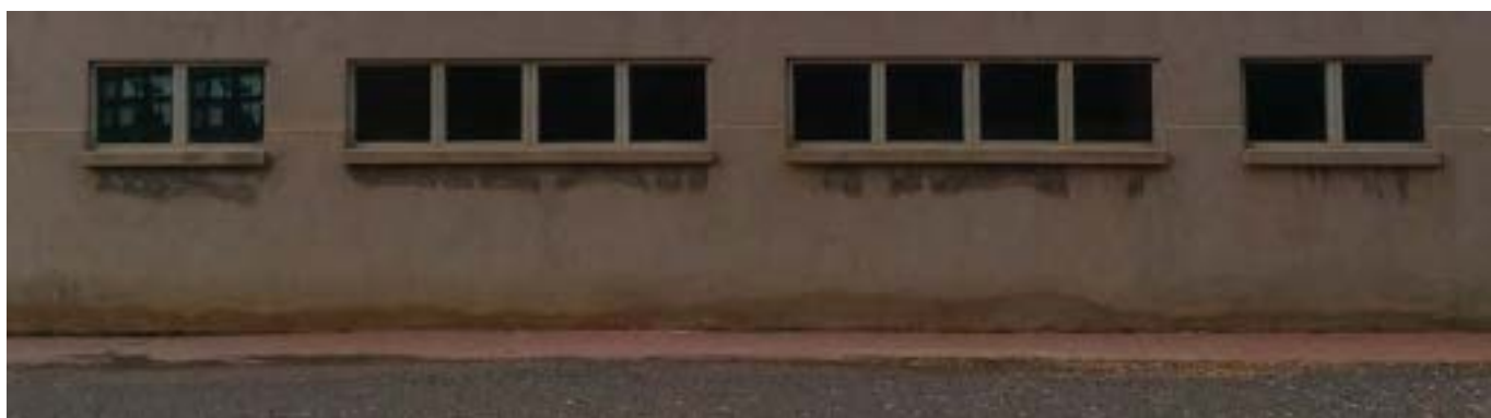
Figura 67. Segni di Infiltrazioni dagli infissi
