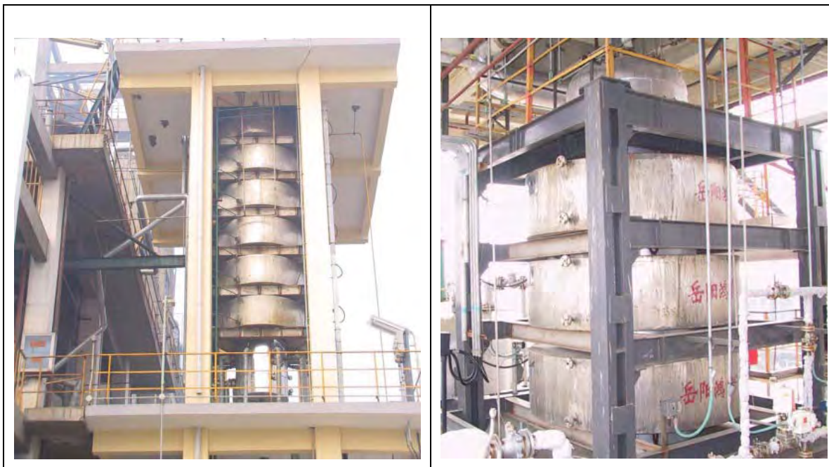
Figura 3.3.4. Due reattori industriali magneticamente stabilizzati per la purificazione ( hydrorefining ) del caprolattame: 200 kt/anno (a sinistra) e 300kt/anno (a destra).
