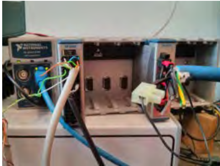
Fig. 12- Connessioni verso il CompaqDAQ
