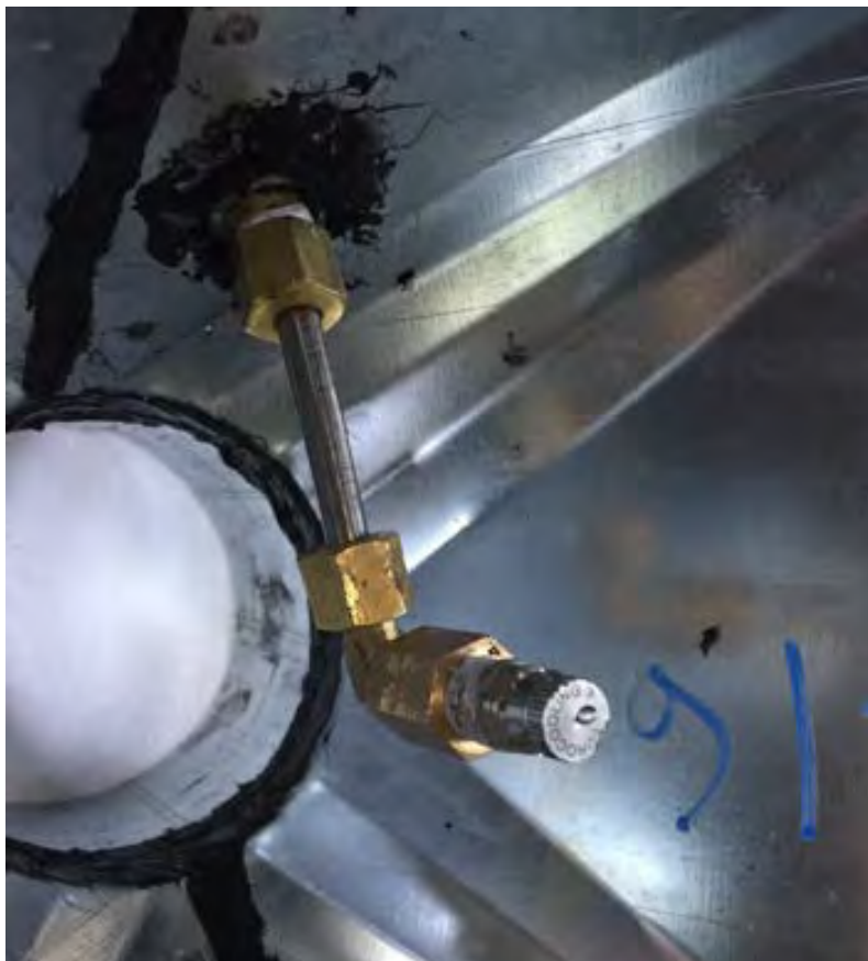
Figura 16. Ugello interno all' umidificatore alimentato dalla pompa dosatrice.
