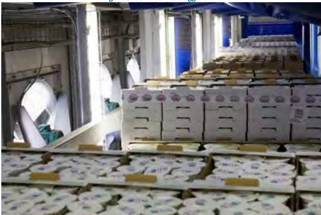
Figura 10 Tunnel per il free cooling
