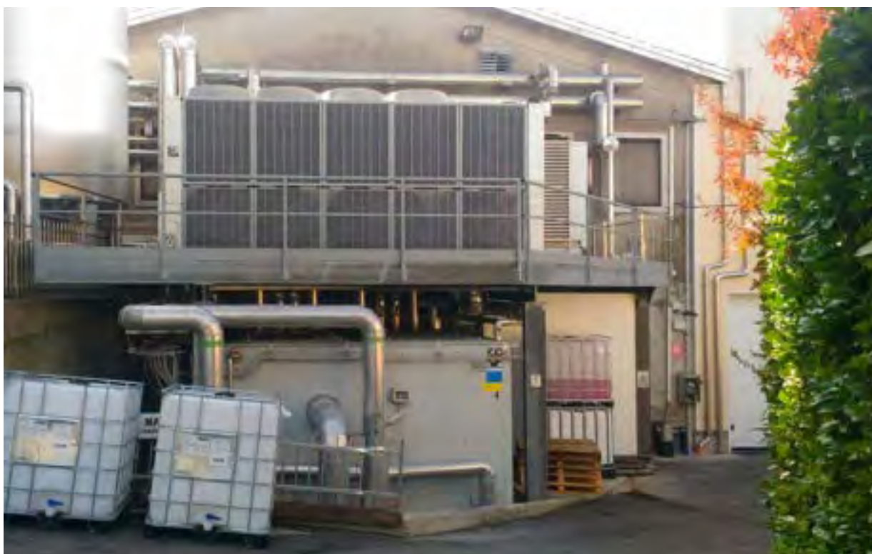
Figura 7: Vasca Acqua Gelida e Chiller 3 e 4
