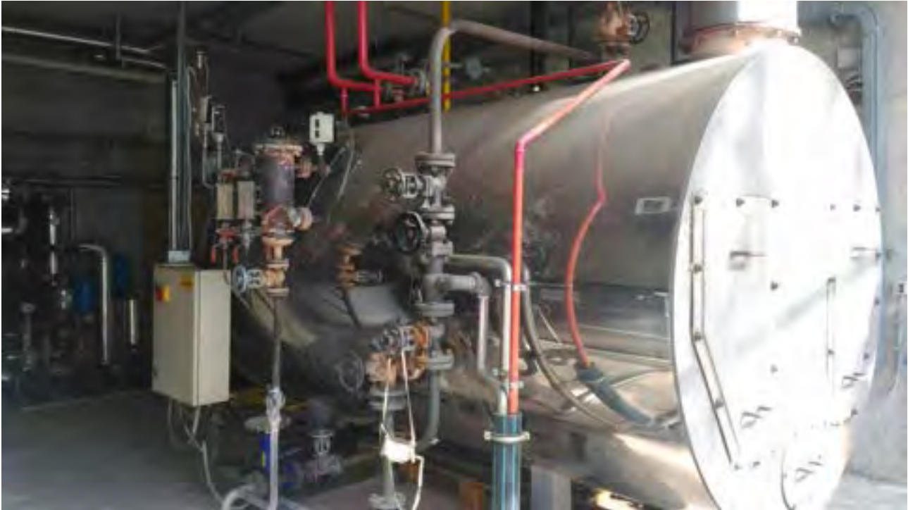
Figura 6 Generatore di Vapore Mingazzini
