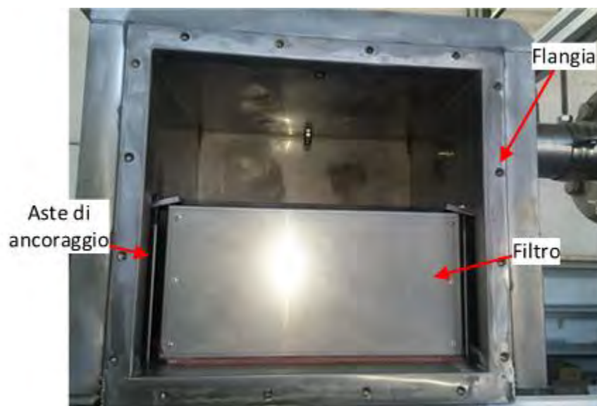
Figura 3.4 Foto interna del plenum con filtro Hepa montato
