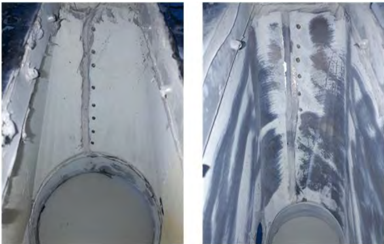
Figura 3.1 – Stato condotti STEAM; a sinistra un plenum ricoperto di ossido di zinco; a destra un plenum dopo il raschiamento dello strato di ossido
