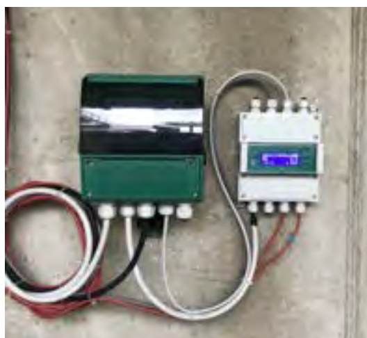
Figura 5 Assorbimento elettrico alla caldaia
