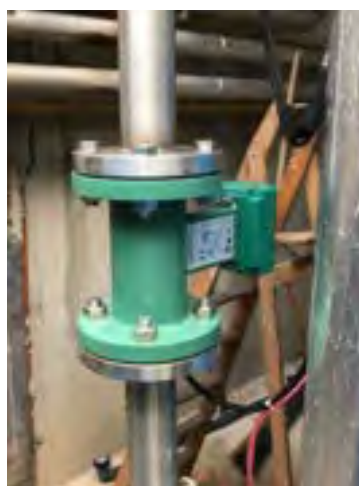
Figura 6 Energia Termica ai cogeneratori
