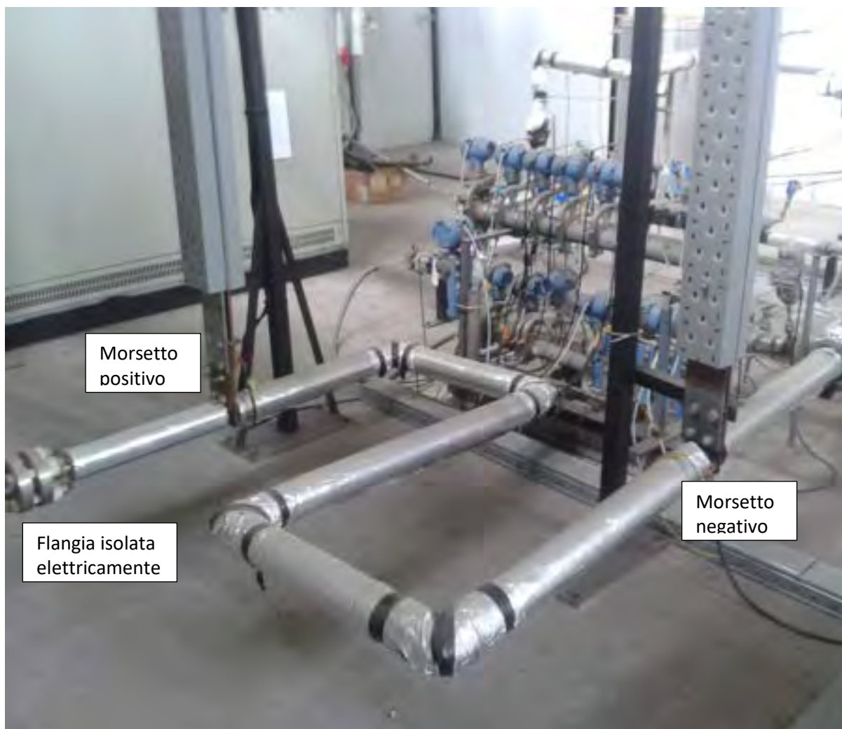
Figura 6 –Caldaia elettrica con barre di alimentazione e flangia isolata
