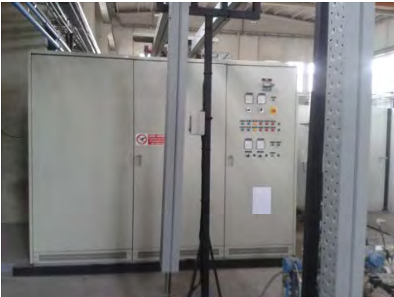
Figura 8 –Alimentatore elettrico in cc e barre di alimentazione caldaia elettrica
