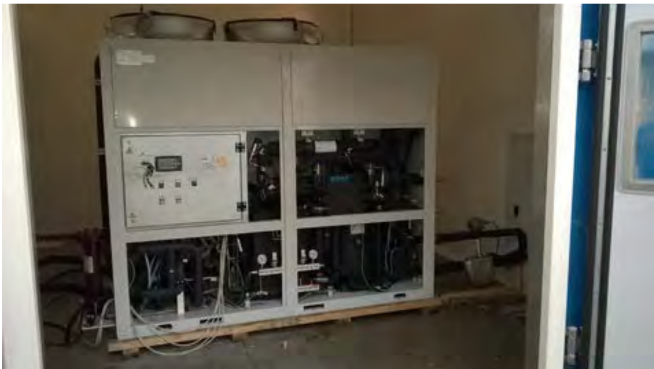
Figura 11. La PdC in test in camera climatica con misuratore di portata sul secondario (a destra)
