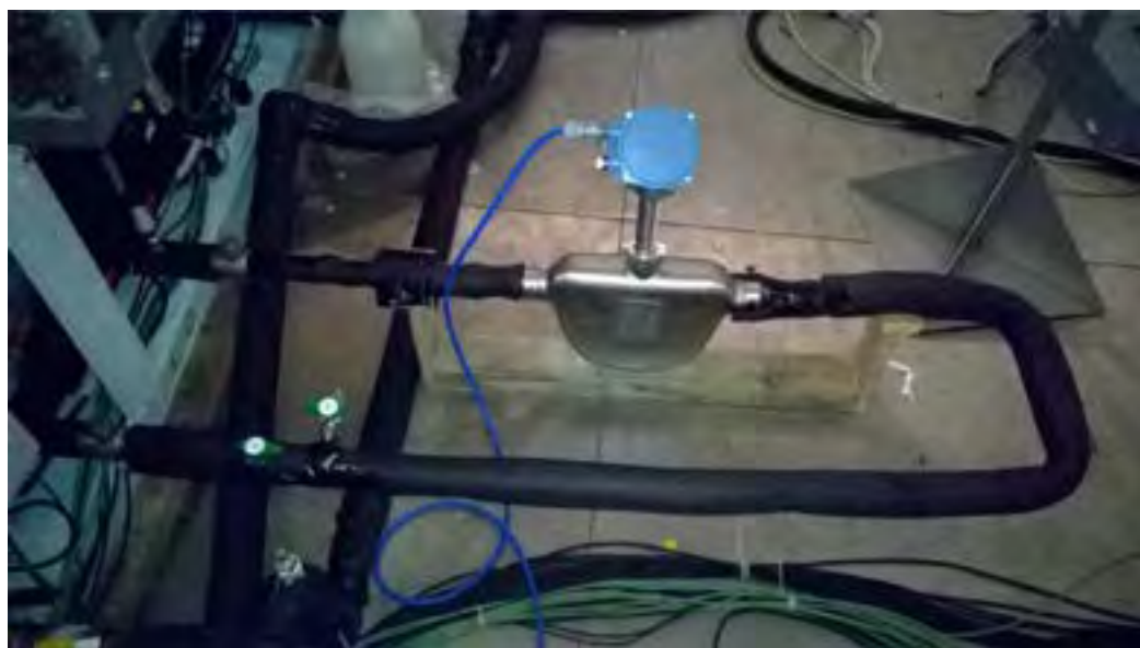
Figura 10. Misuratore di portata installato a vallo dell'IHE, lato caldo
