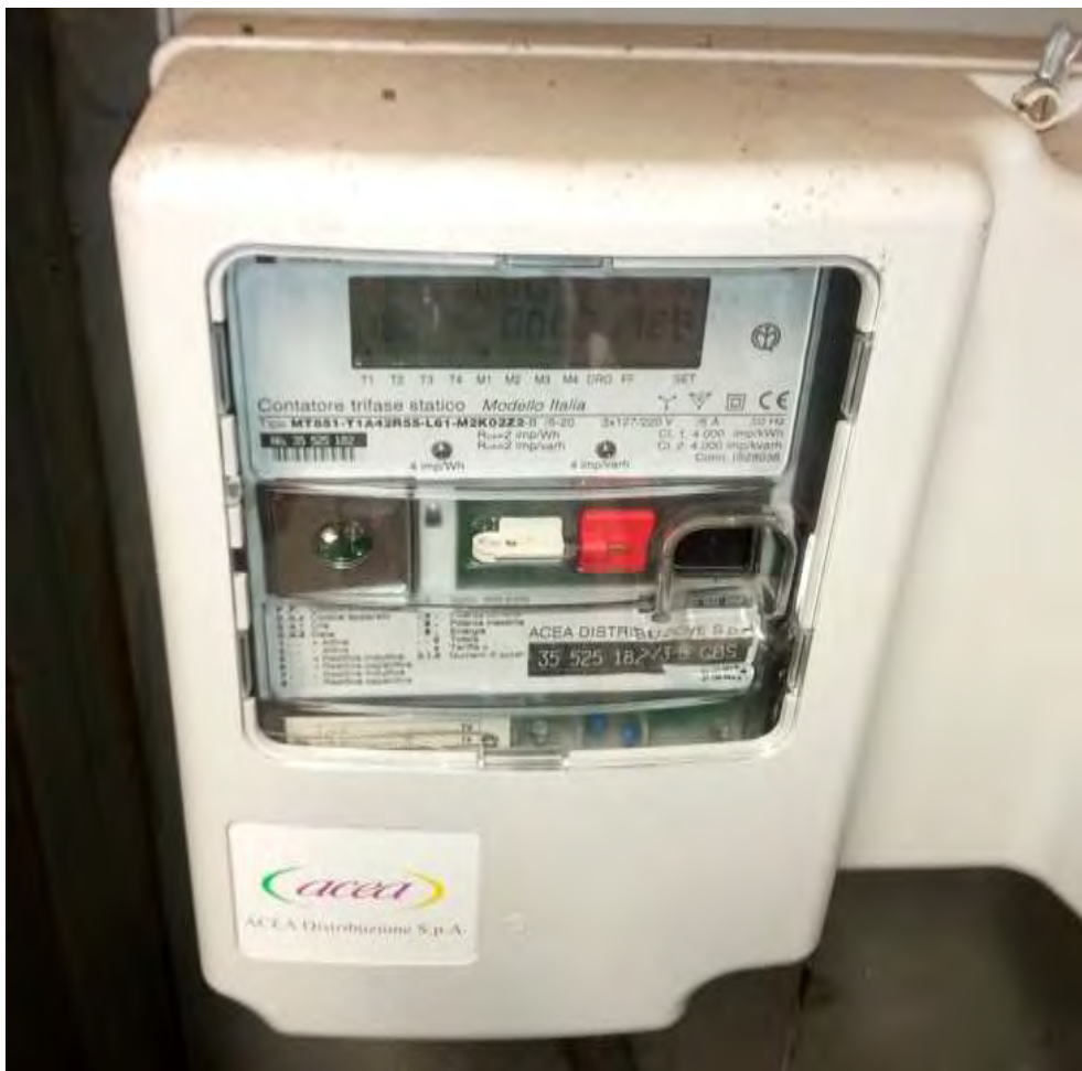
Fig.5.3.9 – Contatore energia elettrica
