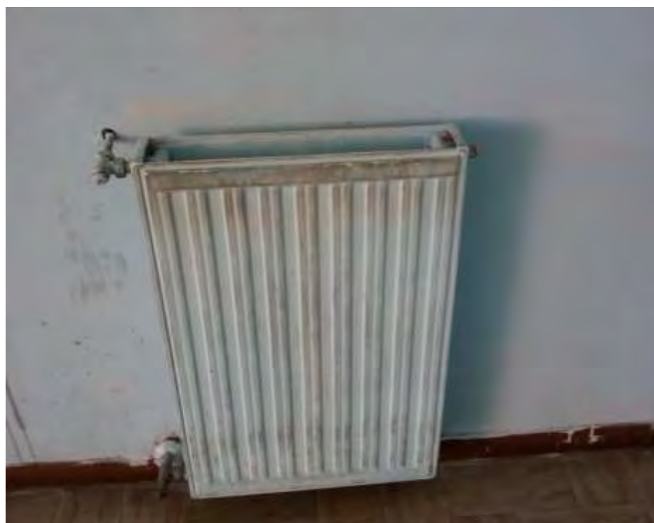
Fig.4.3.2. – Termosifoni con assenza di valvole termostate
