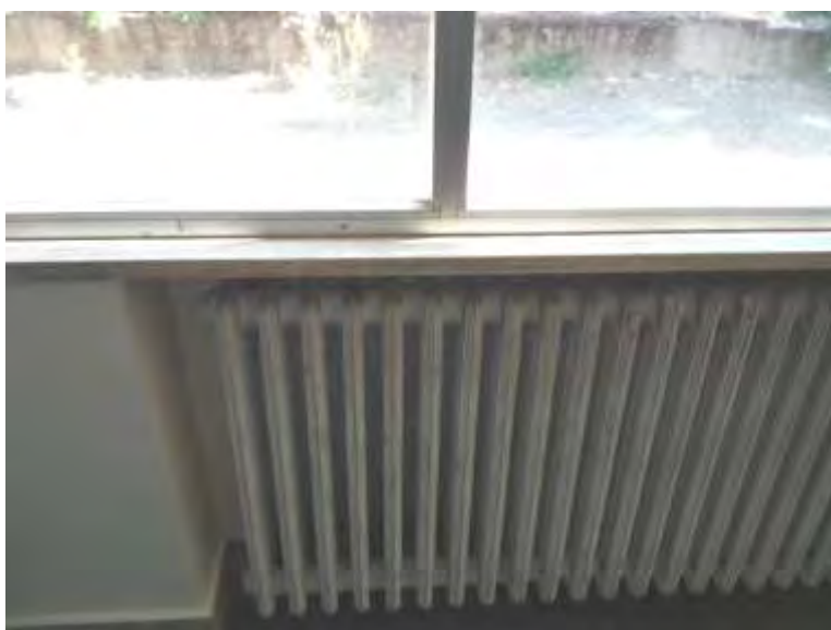
Fig.7.3.7 – Termosifone aula, assenza di valvole termostate
