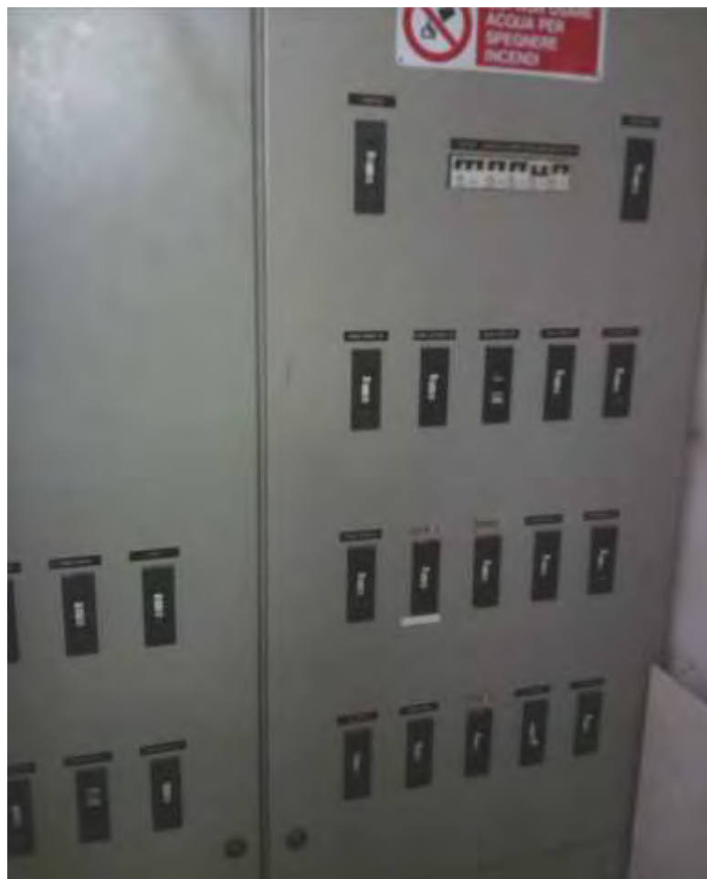
Fig.6.3.2 – Quadro elettrico generale
