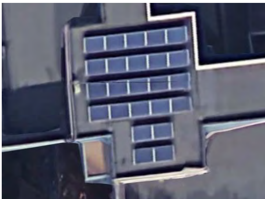
Fig.13.3.2 – Immagine satellitare dell'impianto fotovoltaico
