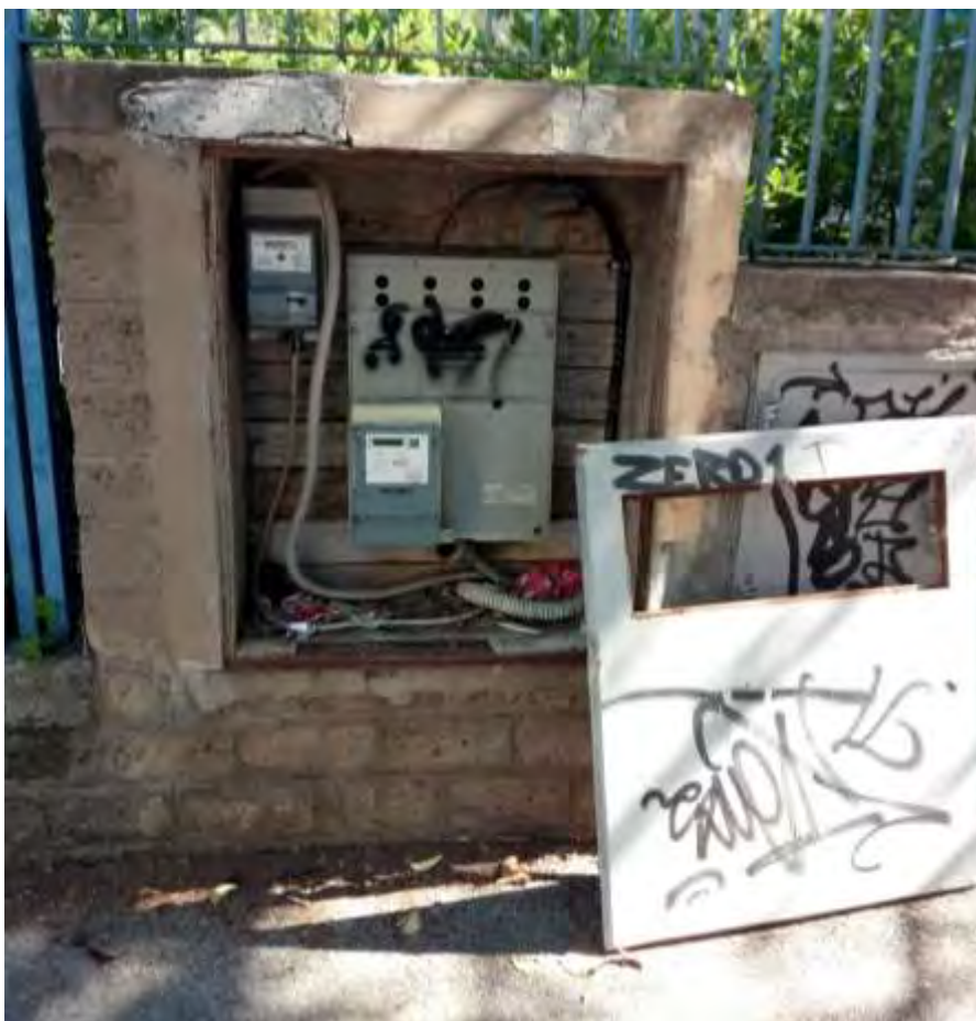
Fig.7.3.8 – Contatori energia elettrica
