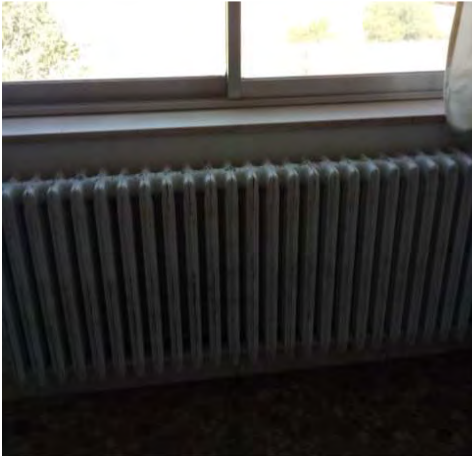
Fig.11.3.2 – Termosifone d'aula, assenza di valvole termostate
