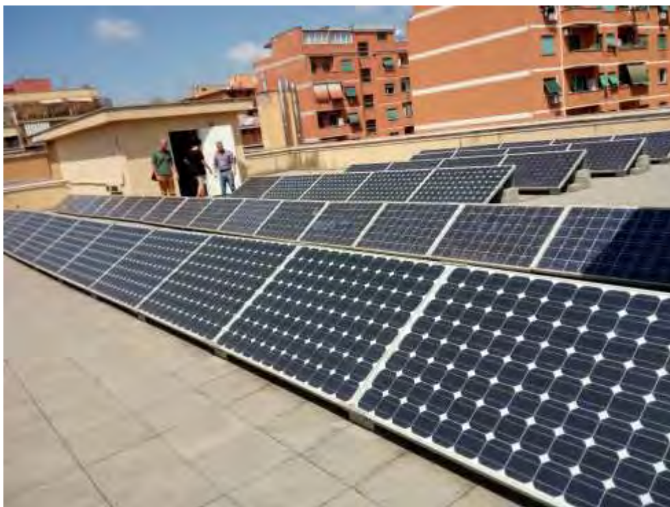
Fig.9.3.4– Impianto fotovoltaico da 14 kW di potenza di picco
