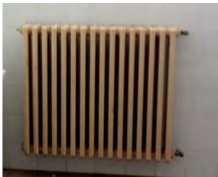
Fig.9.2.2 – Termosifone, assenza di valvole termostate
