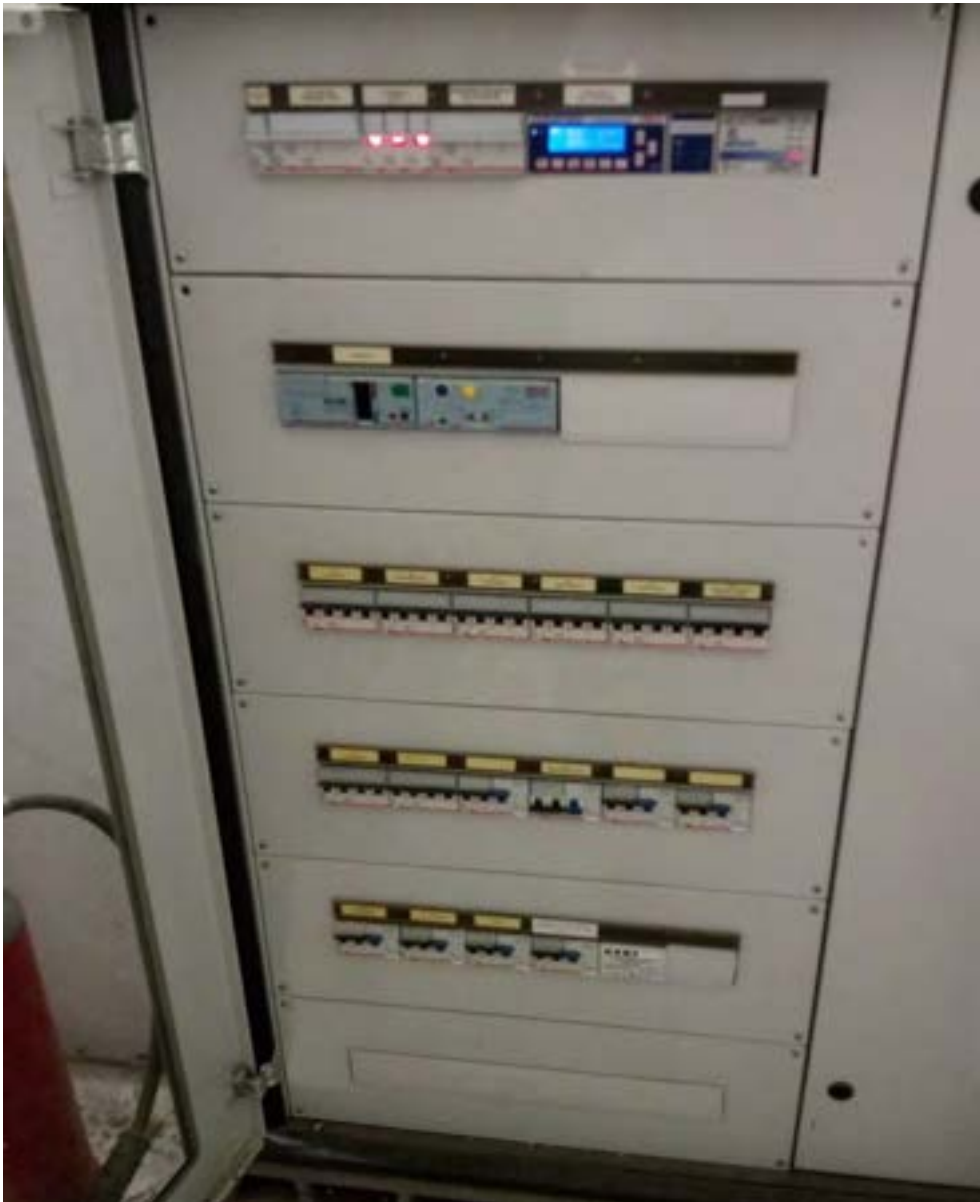
Fig.3.3.9 - Quadro elettrico palazzina A
