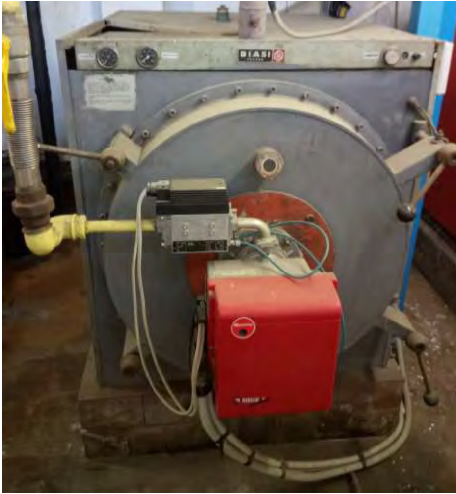
Fig.7.3.2 – Caldaia da 420 kW di potenza termica utile
