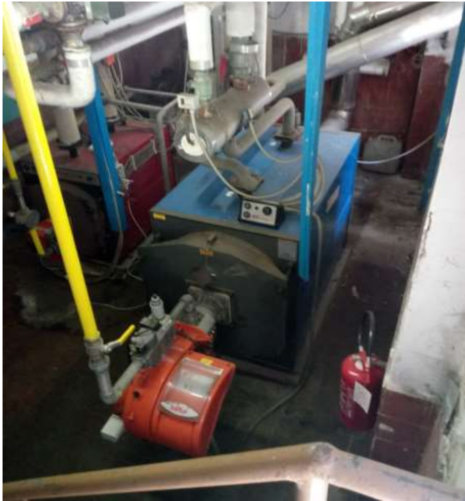
Fig.3.3.1 - Caldaie centrale palazzina A, la caldaia blu è da 396 kW di potenza del focolare mentre quella rossa è da 164 kW
