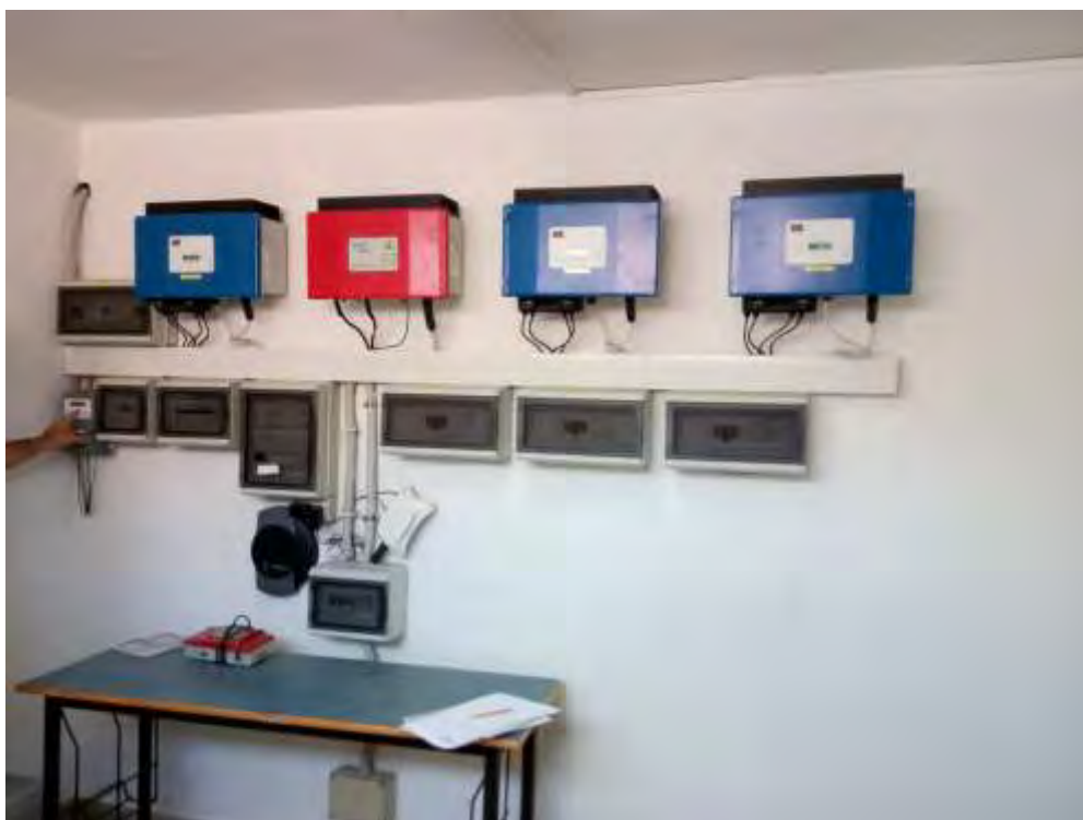
Fig.9.3.5 – Inverter e quadri relativi all'impianto fotovoltaico
