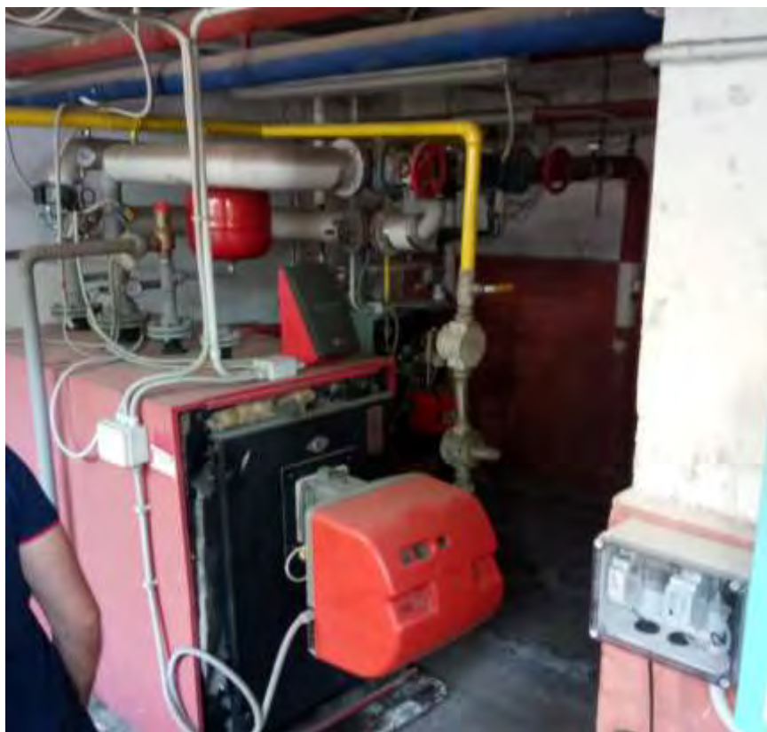
Fig.3.3.4 - Caldaie centrale palazzina B, quella in primo piano eroga una potenza massima al focolare di 293 kW mentre quella in secondo piano è da 30 kW
