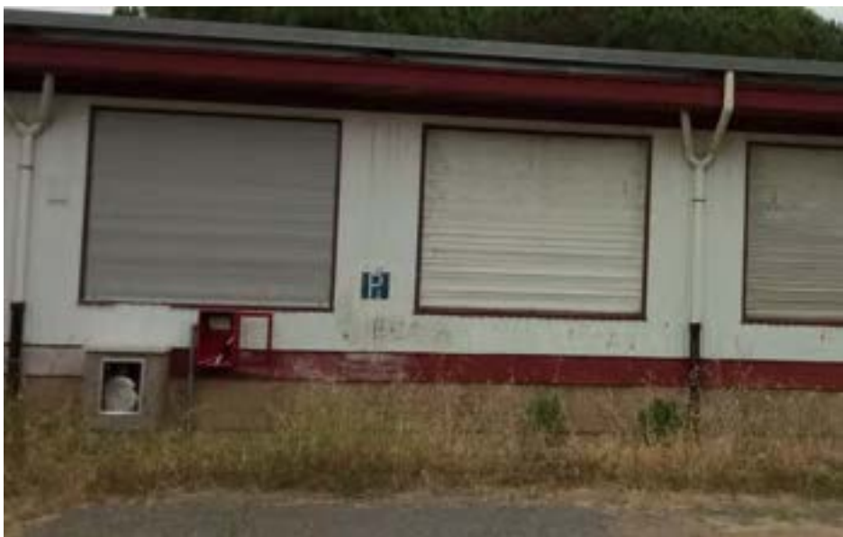
Fig.5.2.6 – Schermatura esterna, avvolgibili in PVC
