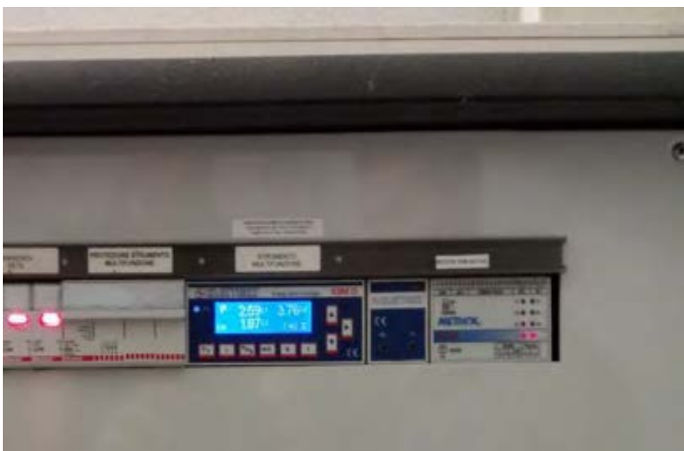
Fig.3.3.11 – Misuratore generale di energia della palazzina A
