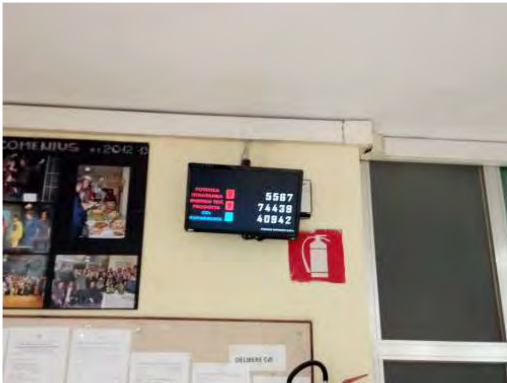
Fig.9.3.6 – Monitor dell'andamento dell'impianto fotovoltaico
