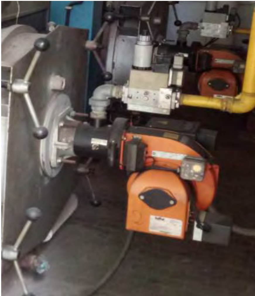
Fig.5.3.4 – Bruciatori da 338 kW ciascuno
