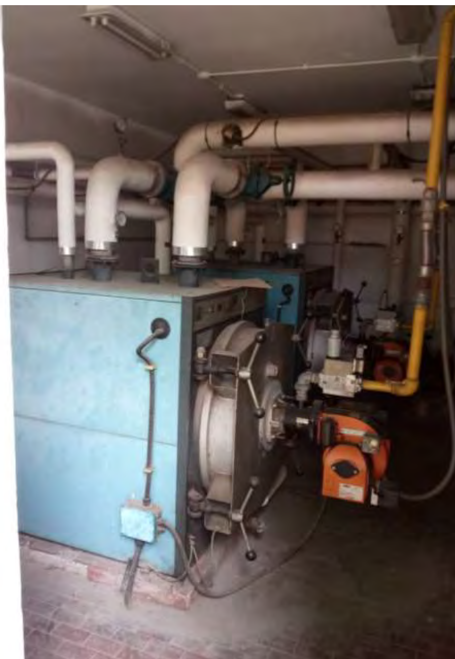
Fig.5.3.3 – Caldaie da 250 kW ciascuna
