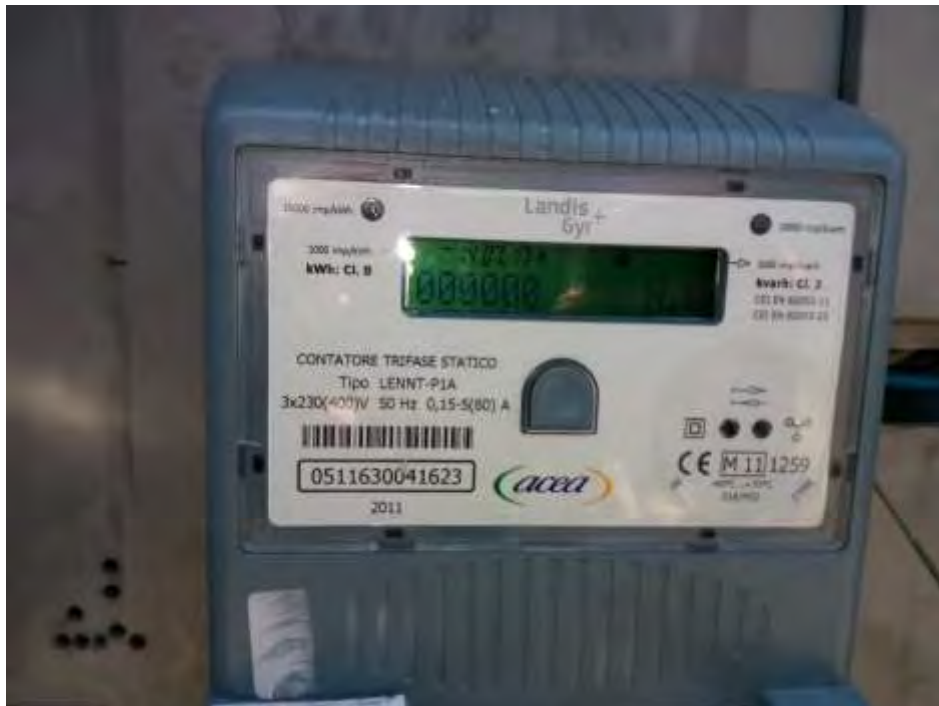
Fig.10.3.3 – Contatore energia elettrica, non funzionante
