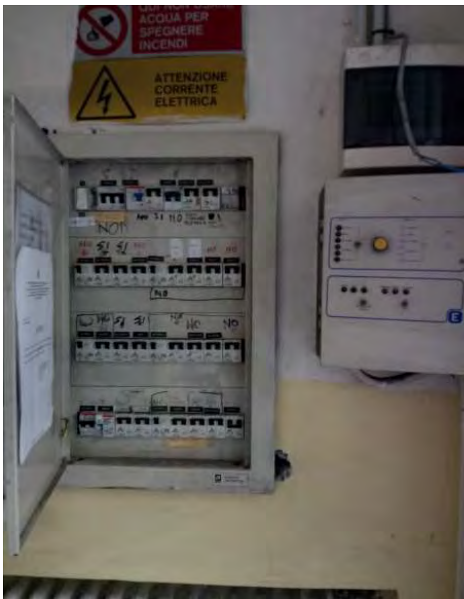
Fig.6.3.3 – Quadro elettrico di piano
