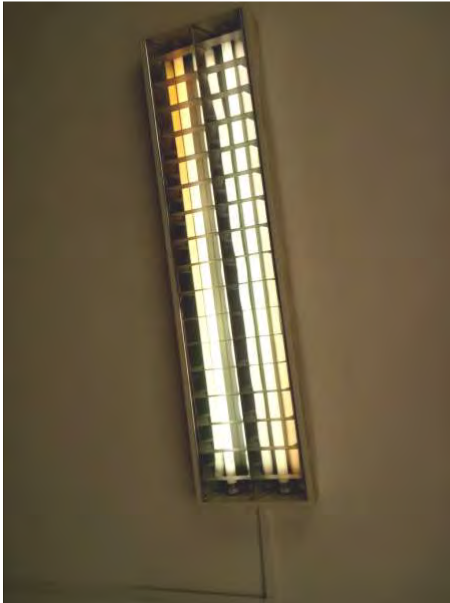
Fig.9.3.3 – Tipologia di lampade installate
