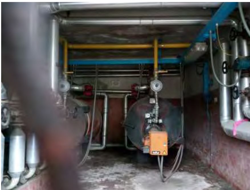
Fig.5.3.5 – Caldaie di una centrale non accessibile
