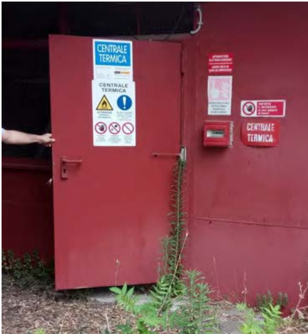
Fig.5.3.2 – Centrale con la porta rotta
