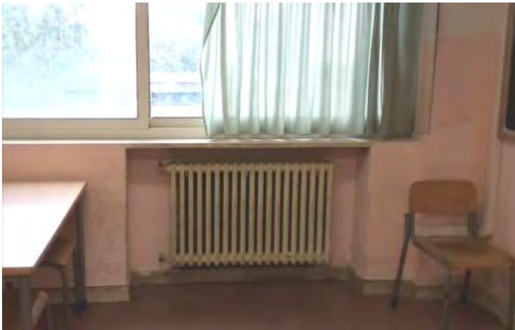
Fig.6.3.1 – Termosifoni in ghisa, assenza di valvole termostate
