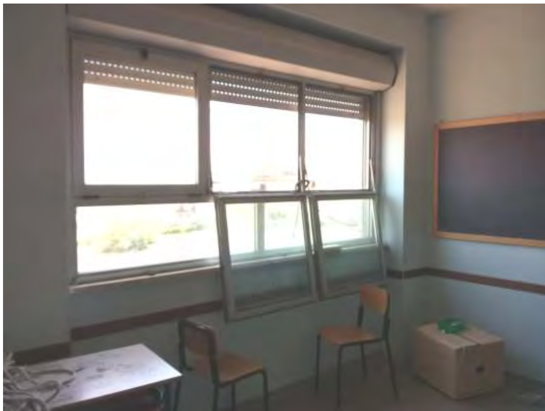
Fig.10.2.1 – Tipologia dell'aula (1), le finestre risultano ribaltate in questa foto per motivi di lavori straordinari
