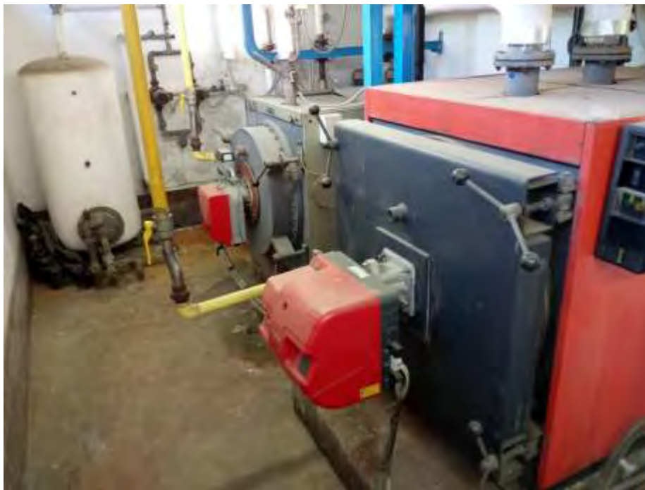
Fig.7.3.1 – Locale termico, caldaie
