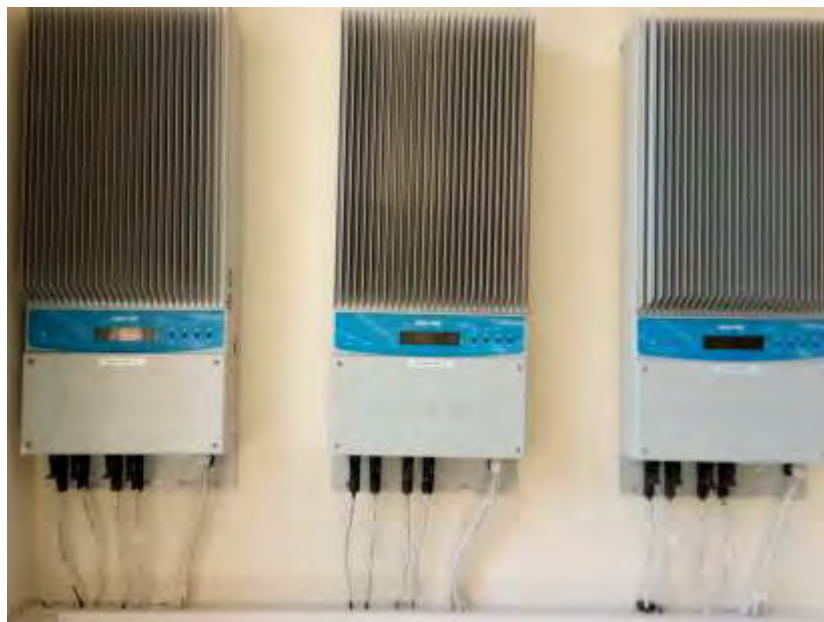
Fig.4.3.6 – Inverter impianto fotovoltaico
