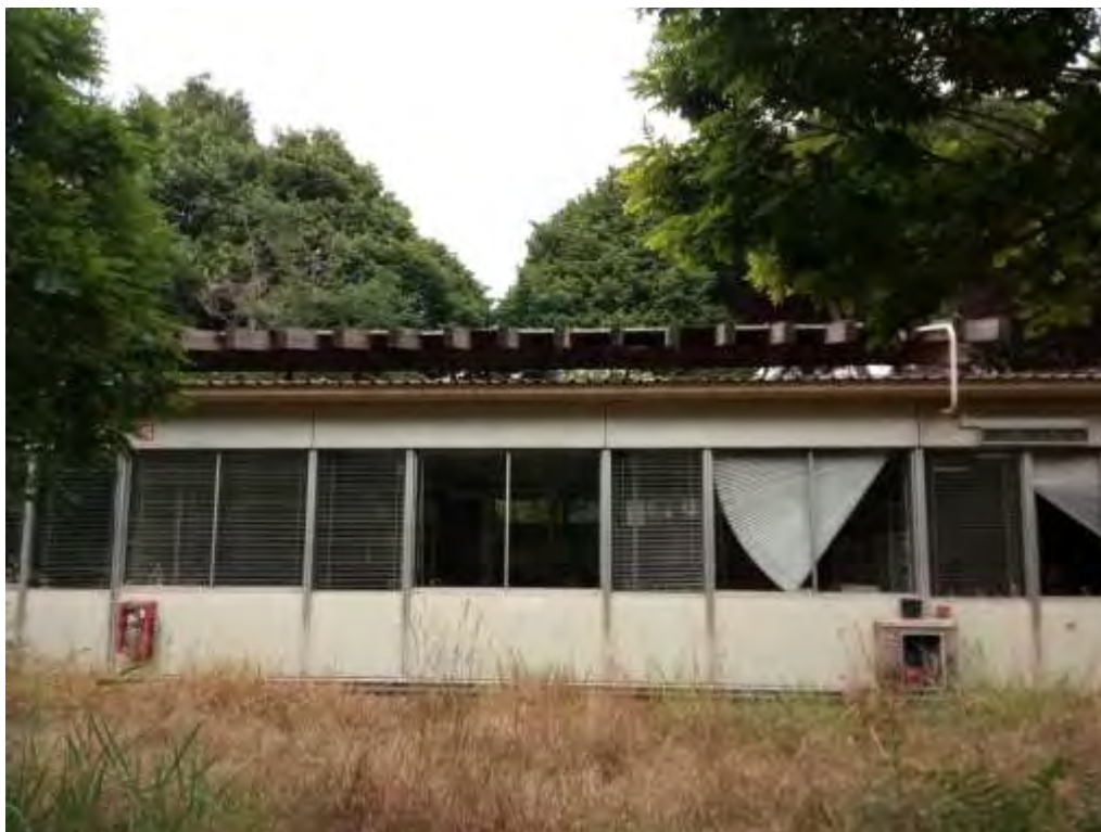
Fig.5.3.13 – Foto del tetto con i pannelli installati
