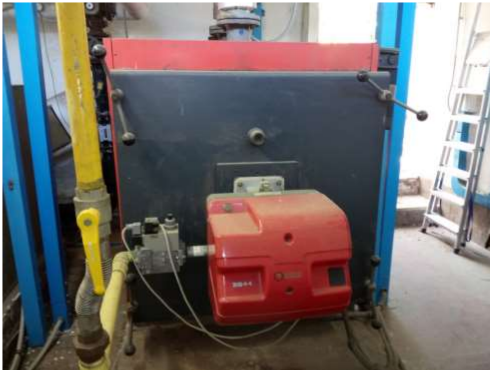
Fig.7.3.4 – Caldaia da 550 kW di potenza termica massima
