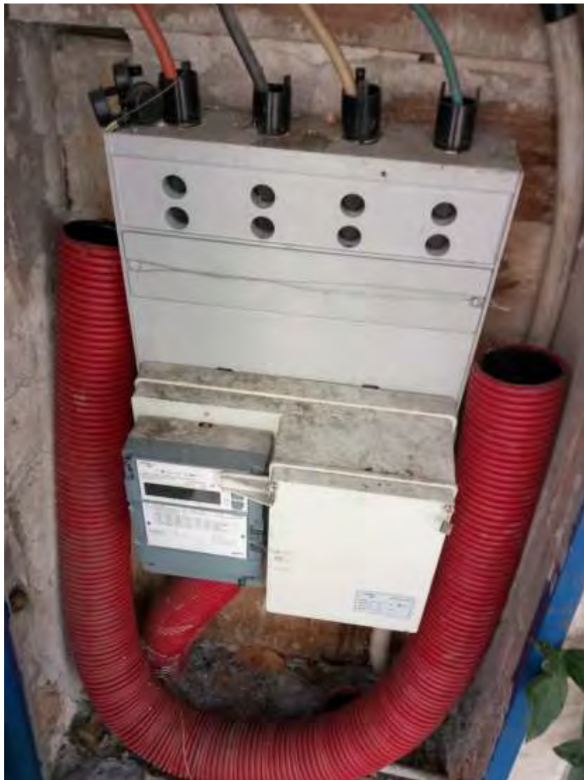
Fig.13.3.1 – Contatore energia elettrica
