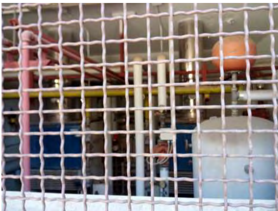
Fig.4.3.1. – Vista esterna della centrale termica
