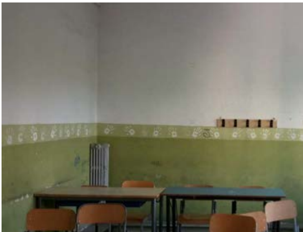
Fig.3.3.7 - Termosifone aule, assenza di valvole termostate
