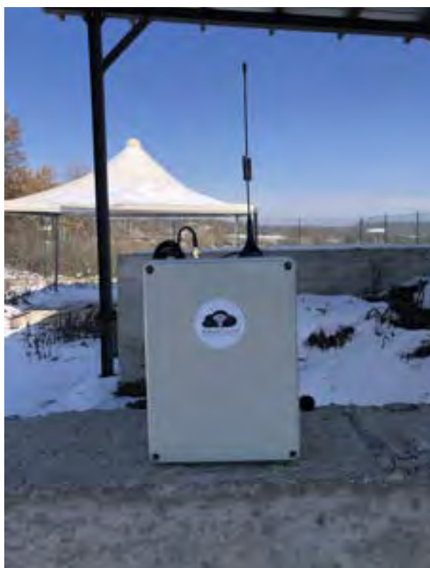
Figura 126: Particolare del sistema ricevente modem/router con ante
