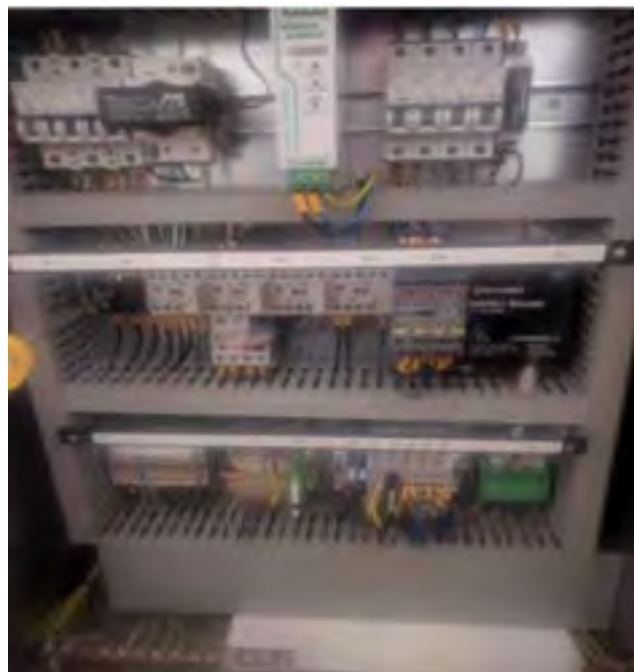
Figura 122: Quadro elettrico del compostatore Big Hanna
