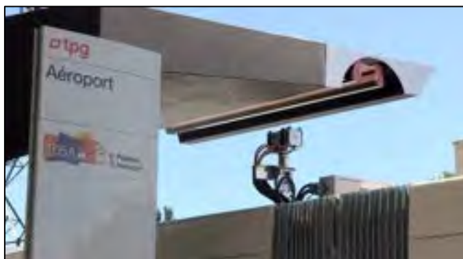
Figura 12: Esempio di ricarica con collegamento pantografo a stazione di ricarica (Sistema TOSA a Ginevra) Fonte: ABB 2013
