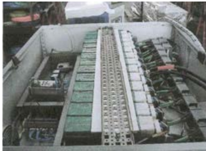
Figura 5. Foto del modulo batteria oggetto di analisi
