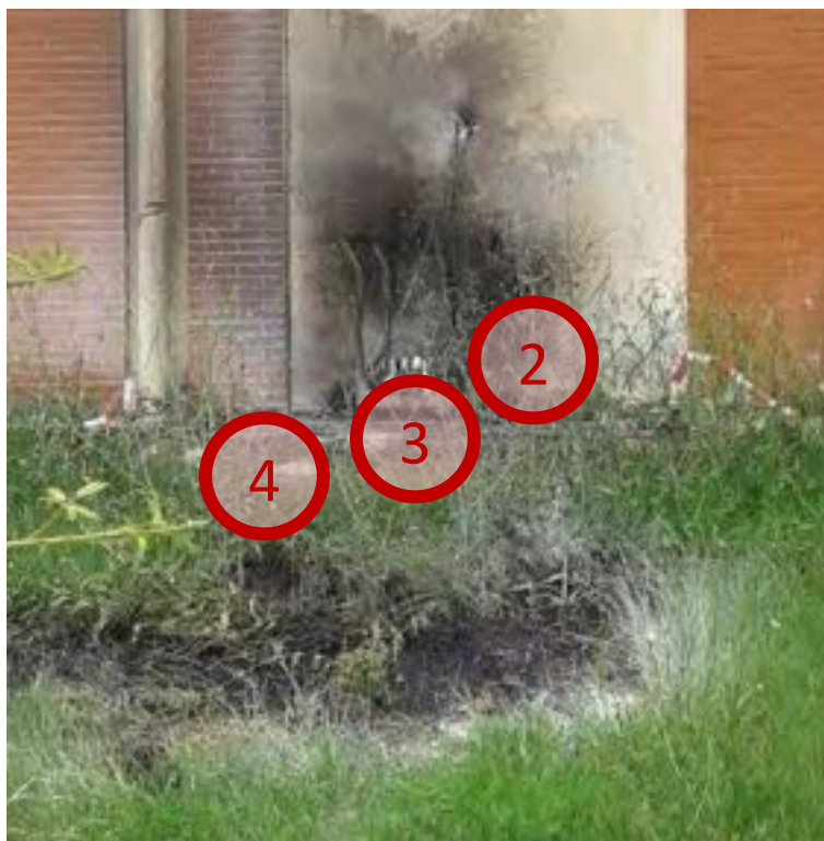
Figura 17 Batteria incendiata, punti di prelievo campioni.
