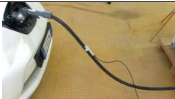
Figura 53 – Punto di misura sul cavo DC a 3 m dall'uscita dal pannello
