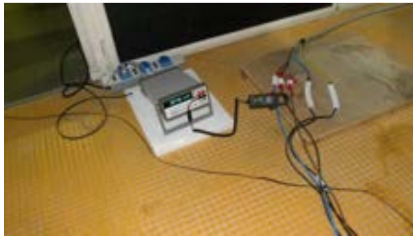
Figura 8 – Misura della corrente di alimentazione (fase R)
