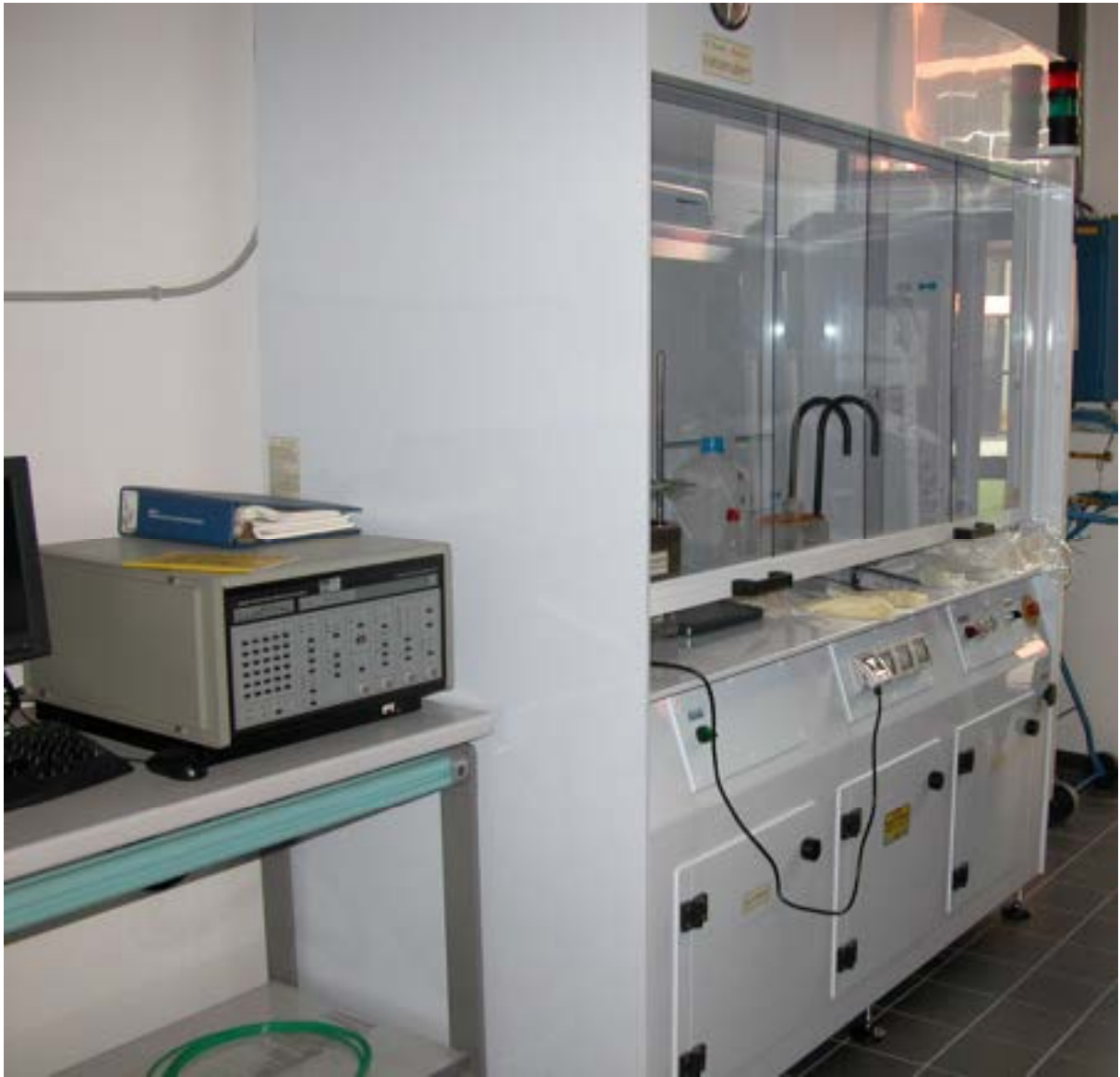
Foto della cappa installata nel Laboratorio Cella Fotovoltaiche Polimeriche .
