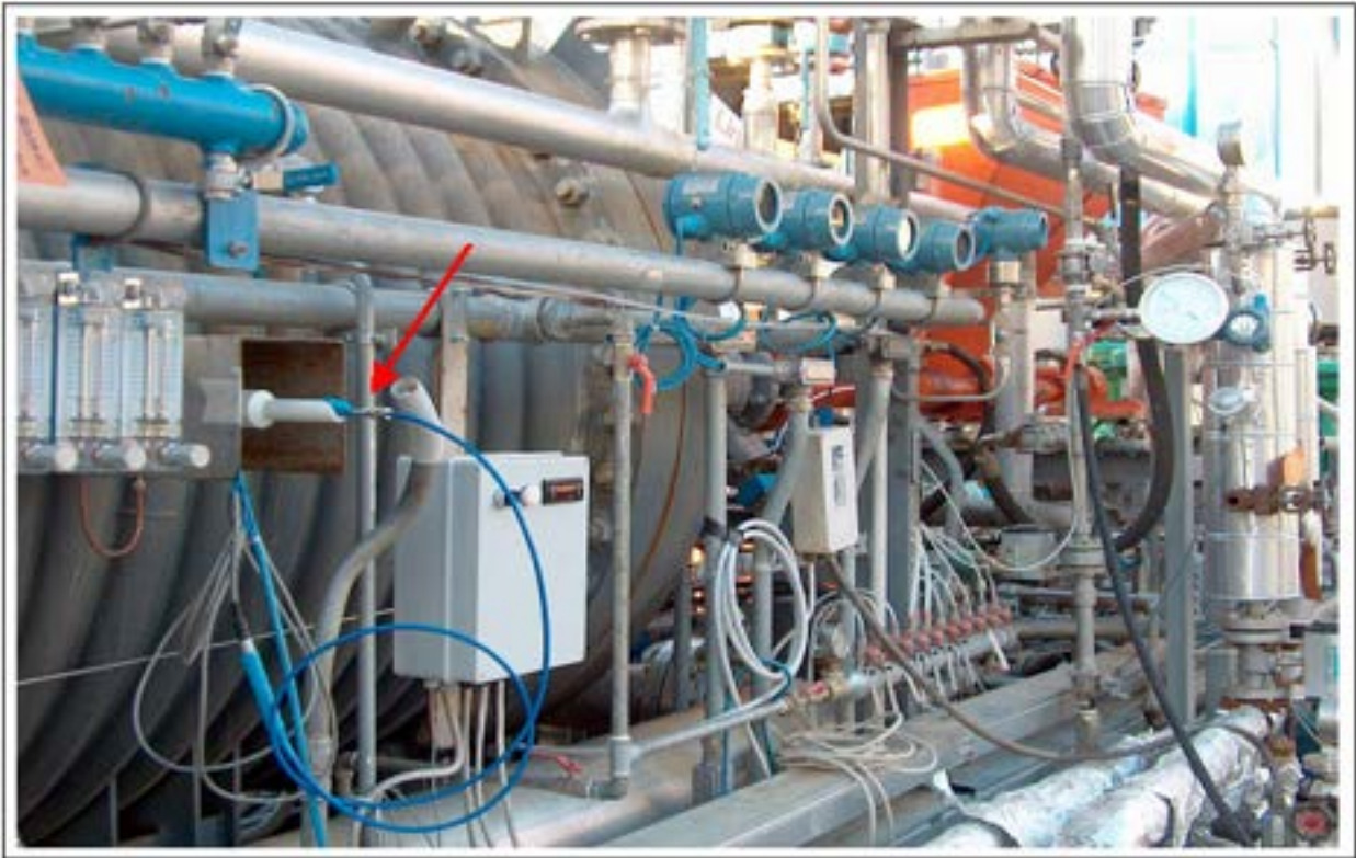
Figura 5.7: Immagine dell'impianto con il set up B con sensore OSI1-300k/10M.
