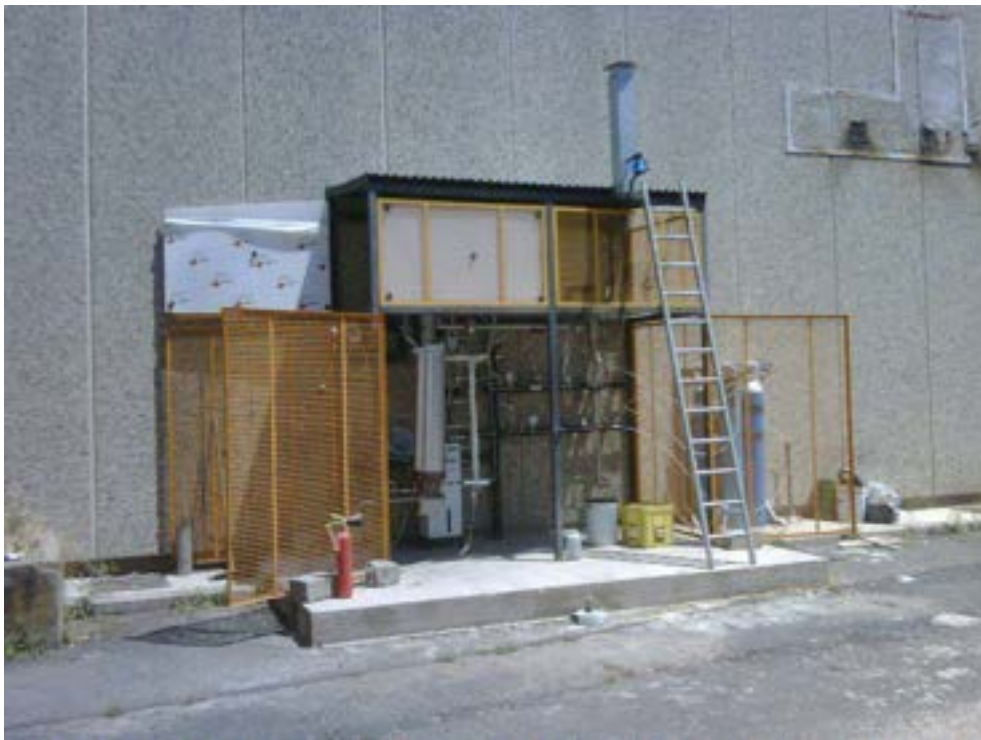
Fig. 1: Mini impianto di gassificazione GESSICA
