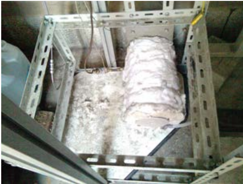
Figura 16: Generatore di vapore
