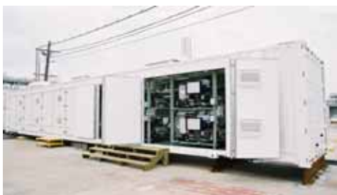
Moduli PEFC (300 kW) installati presso la Dow Chemical di Freeport, Texas
