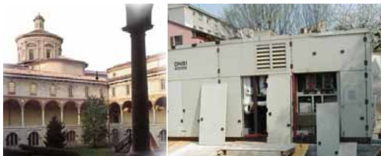
Impianto PureCell™ 200 presso il Museo della Scienza e della Tecnica di Milano
