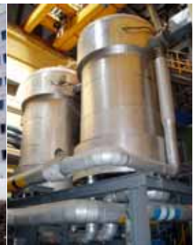
Stack PAFC da 670 kW
