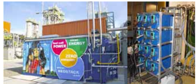
Impianto pilota installato da 50 kW presso la Akzo Nobel e modulo PEFC (12 stack da 10 kW)
