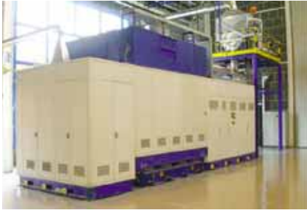
Unità CHP100 nella sala prova della TurboCare
