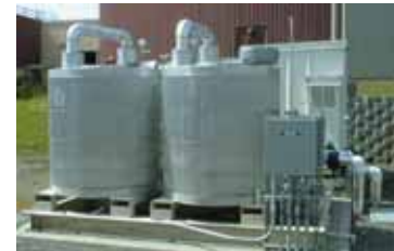
Unità trattamento gas (GPU)
