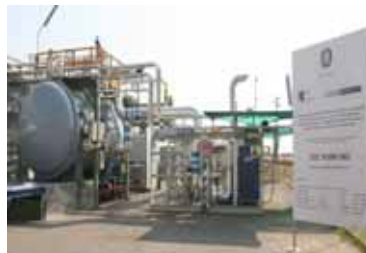
Impianto Tecnodemo da 125 kW (Bosco Marengo, I)
