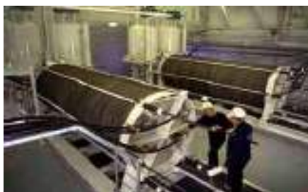
Norsk Hydro Electrolysers (485 Nm 3 /h)
