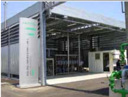
Modulo Forza 120 kW (8 stack) presso il laboratorio di qualifica celle a combustibile Siad/Rivoira (Osio, BG)
