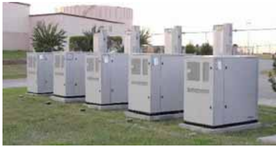
Unità GenSys 5 kW installate presso la base dell'Air Force di Robins (Georgia, USA)
