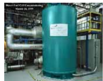
Impianto Direct Fuel Cell da 250 kW
