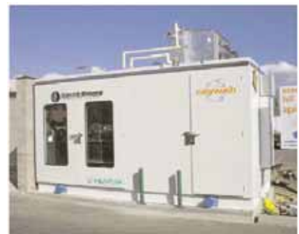
Unità Forza installata presso la Easywash
