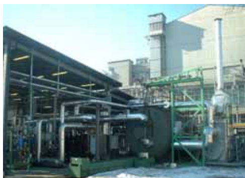
Impianto ibrido MCFC/MTG da 125 kW (CESI Ricerca, Milano)
