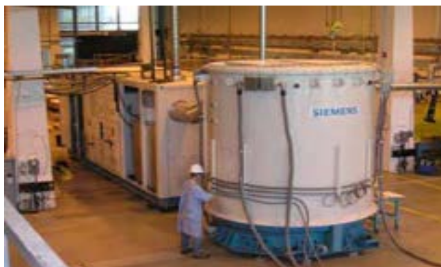
Figura 17. Vista dell'impianto Siemens SFC-200: è possibile osservare il modulo elettrochimico (cilindro alto circa 3 metri) e il box contenente gli ausiliari.
