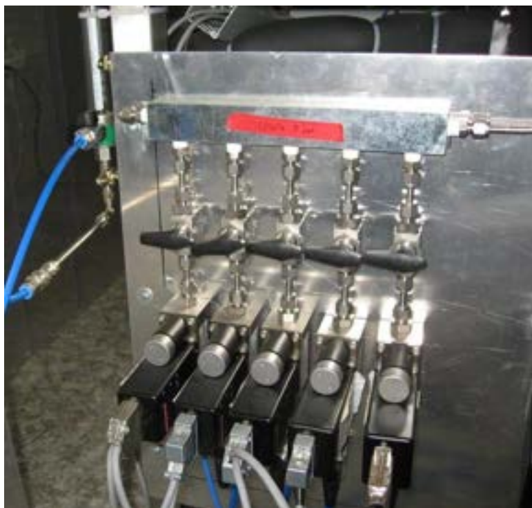
Figura 40. Flowmeters e manifold lato catodico.
