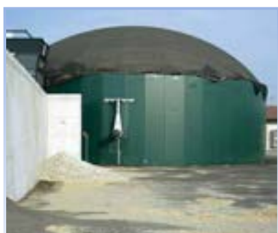
Figura 8 – Gasometro con una semplice membrana elastica in gomma (Epdm)
