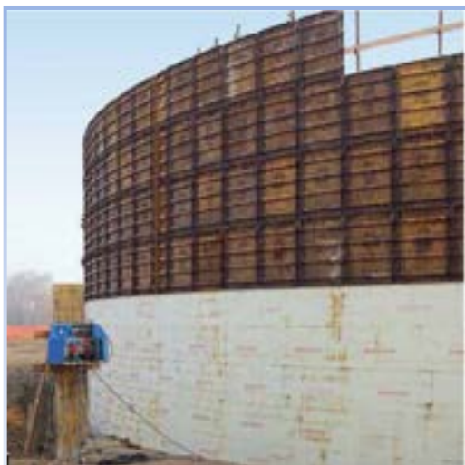
Costruzione di un digestore in opera con l'utilizzo di speciali casseri metallici
