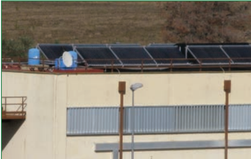
Campo solare Edificio F51 ENEA-CASACCIA
